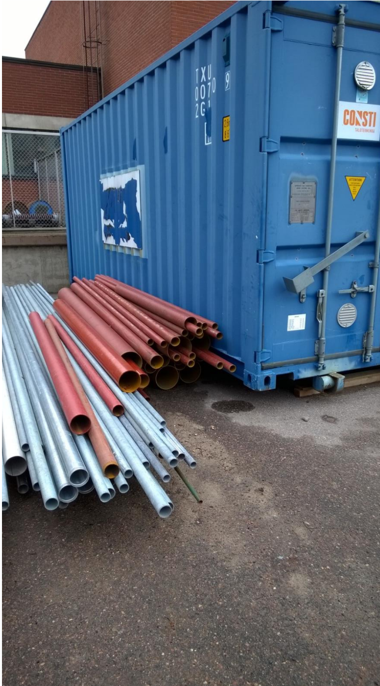
Kuva 10. Putkien varastointia ulkotiloissa.
