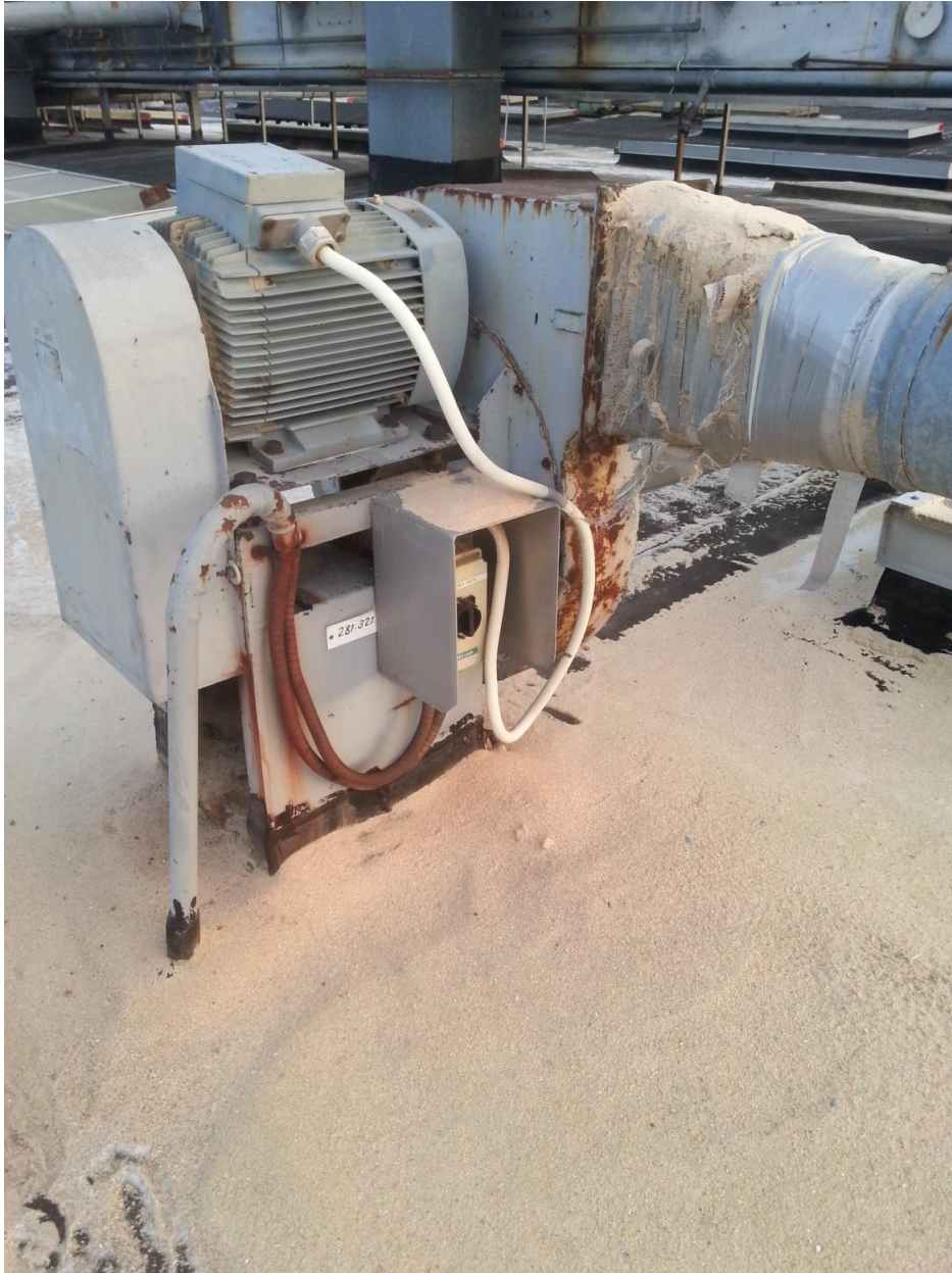
Kuva 8. Siirtopuhaltimen 281 321 teippikorjauksia ja ympäristö
