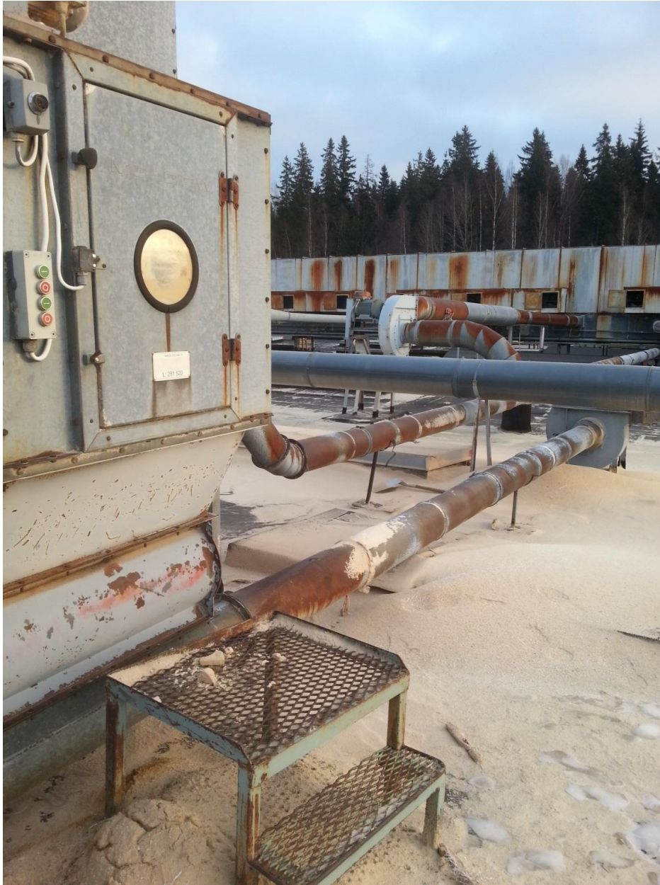
Kuva 6. Puru-Moldow 5:n sulkusyöttimen ympäristö
