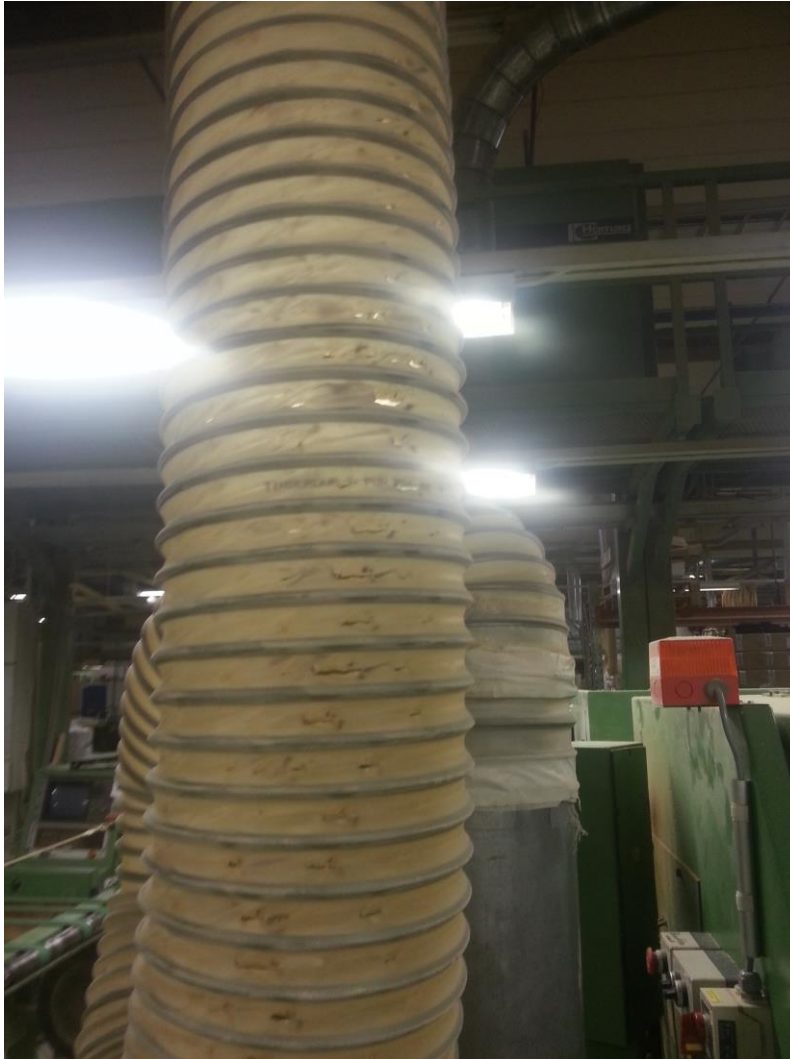
Kuva 5. TL-4 tuotantolinjan haitariputkien kunto
