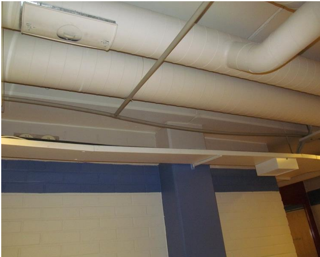
KUVA 15. Notkahtanut putki 2 (Kuva: Janne Mäenpää 2015)
