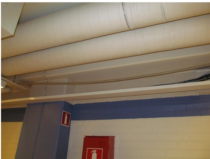
KUVA 14. Notkahtanut putki (Kuva: Janne Mäenpää 2015)
