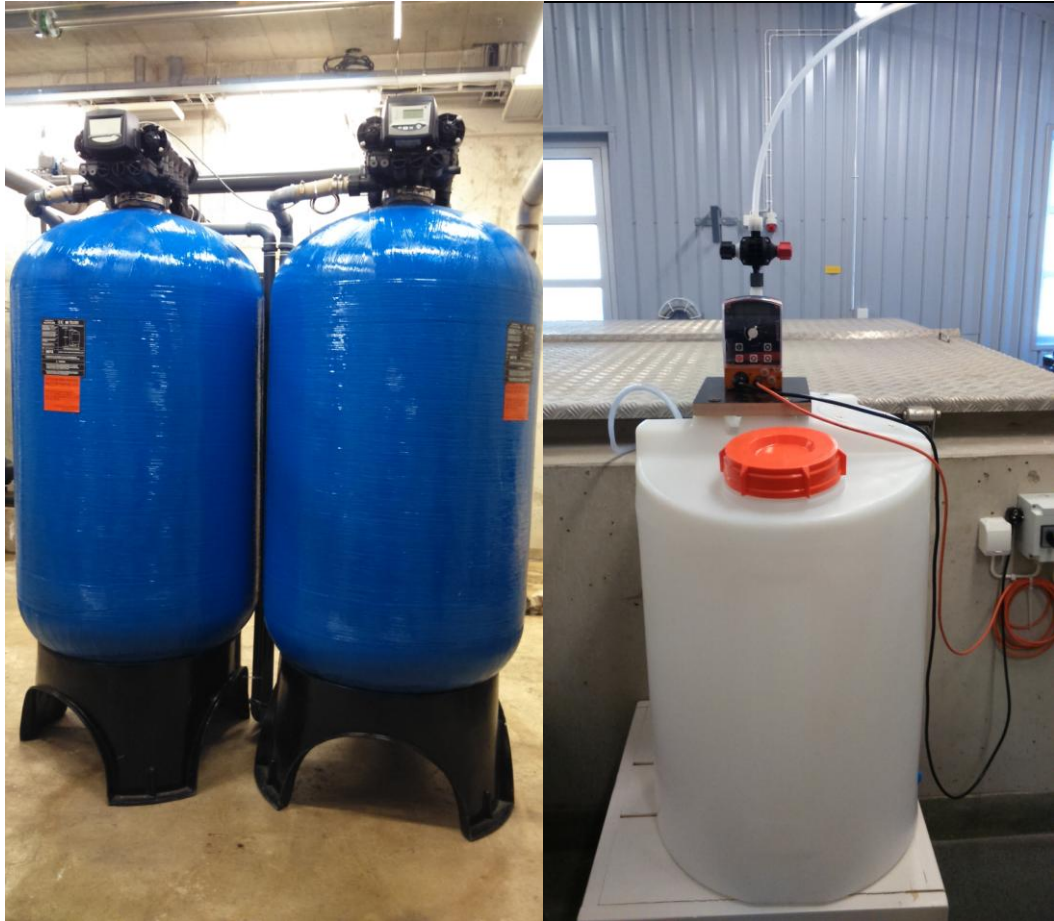
KUVA 5. Aktiivihiilisuodatusjärjestelmä ja desinfiointijärjestelmä (Nieminen 2015).
