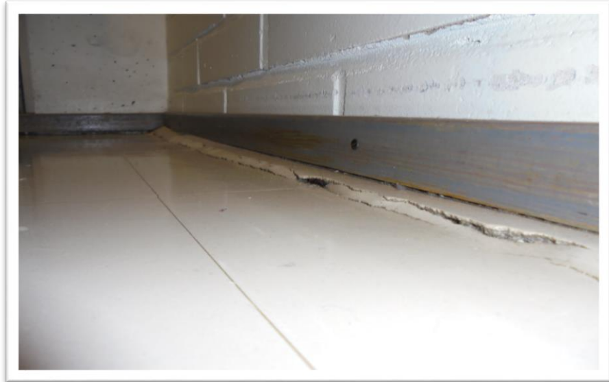
KUVA 3. Esimerkki alapohjan ja seinän liittymän vuotoilmavirtauskohdasta (Tuukkanen 2015)
