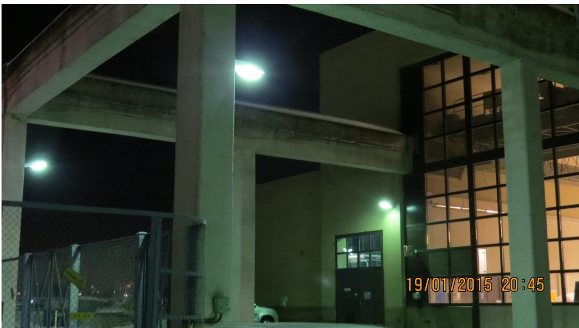
KUVA 7. Voimalaitoksen piha-alueen valaisimia on kiinnitettyä pihan rakenteisiin.
