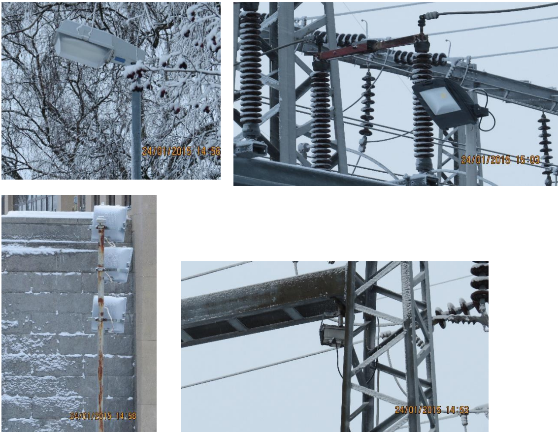
KUVA 15. Voimalan piha-alueen ja kytkinaseman valaisuun käytettyjä valaisinmalleja.
