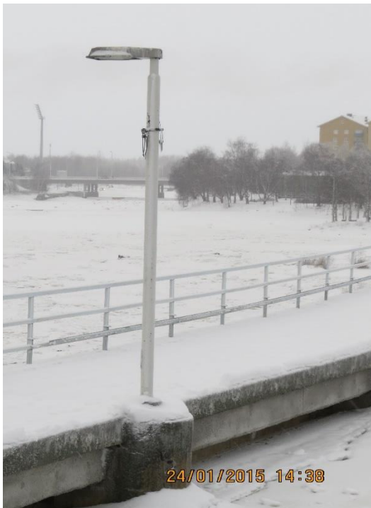
KUVA 13. Lamellipadon päällä kulkevan huoltokäytävän pylväsvälaisin.
