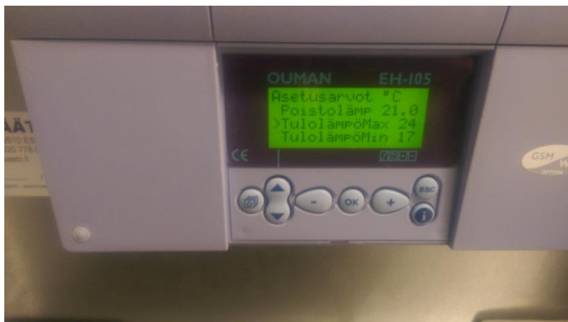
Kuva 16. Yleisilmanvaihtokoneen säädin Ouman EH-105.
