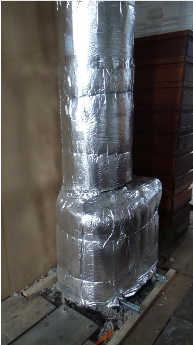
Kuva 10a. Ravintolasalin tuloilmakanava ja -laatikko paloeristettynä ullakkotilassa.
