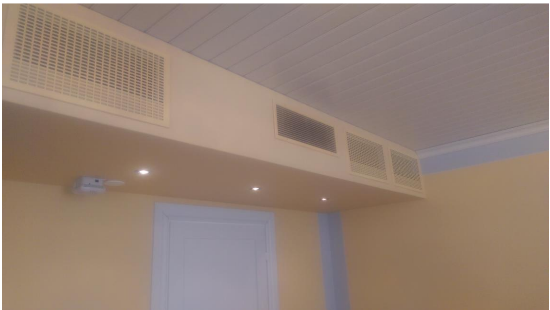
Kuva 9b. Päätelaitteet kotelon asentamisen jälkeen (Kuva Eero Uusimaa).
