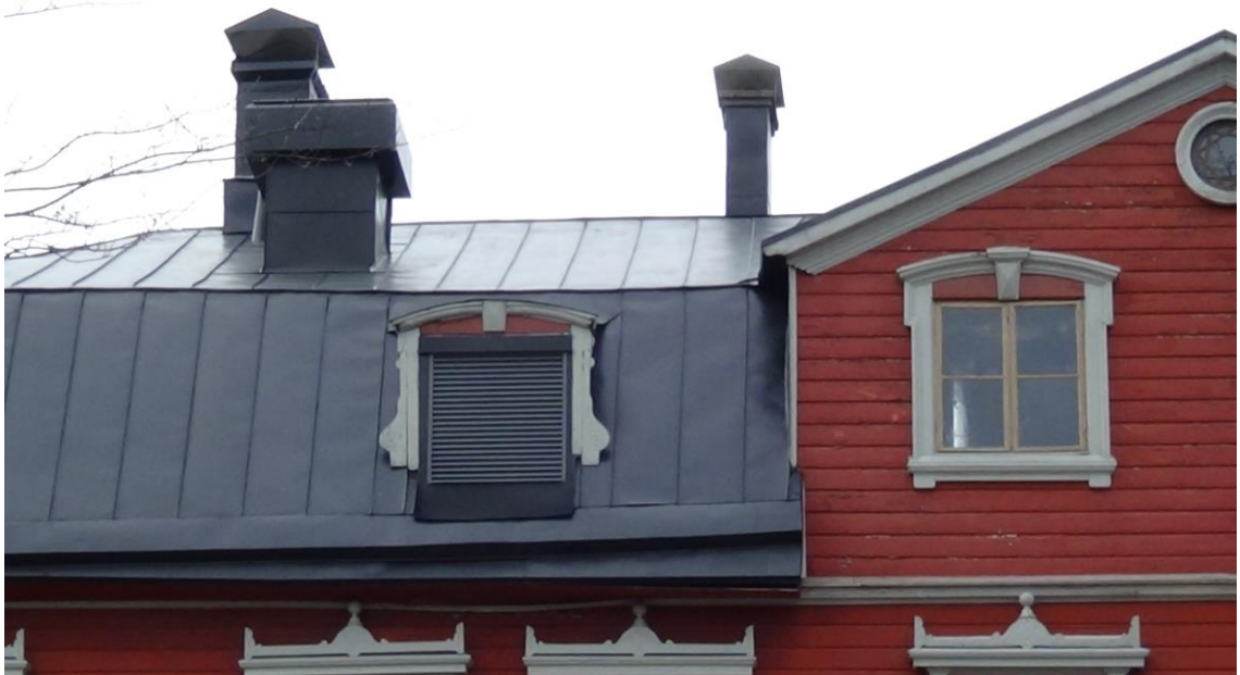
Kuva 3. Yleisilmanvaihtokoneen tuloilmasäleikkö ja jäteilman ulospuhalluslaite
