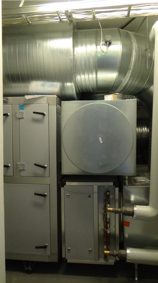
Kuva 14. Tuloilman äänenvaimennin täyttää koko ilmanvaihtokoneen ja katon välisen tilan.
