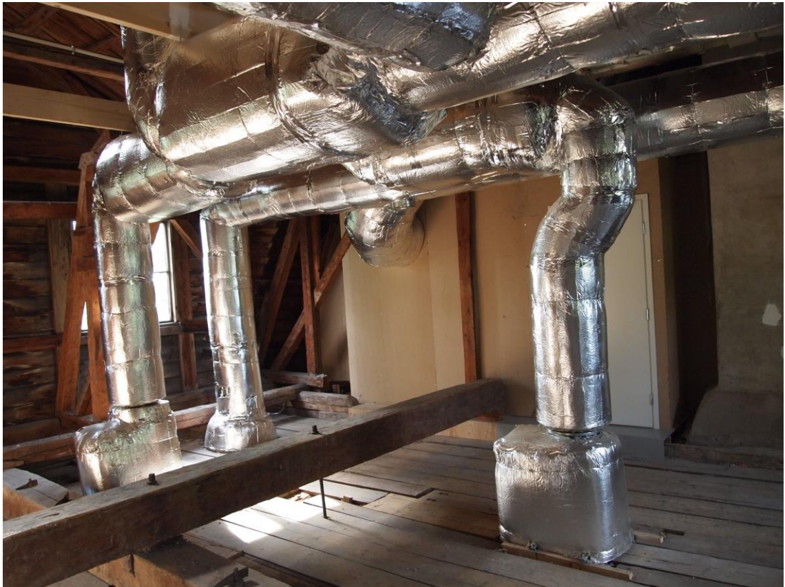
Kuva 5. Ullakon ilmanvaihtokanavistoa palo- ja lämpöeristettynä. Kuva Risto Salmia.
