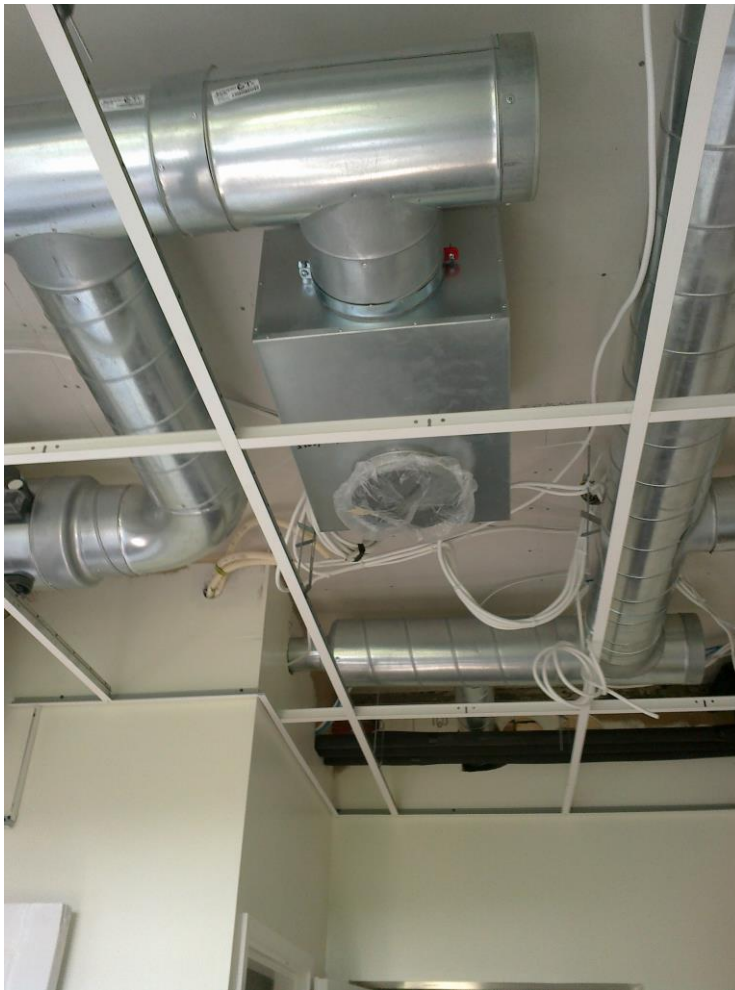
Kuva 6. Baaritilan kanavistoa ja tuloilmalaitteen äänenvaimennuslaatikko
