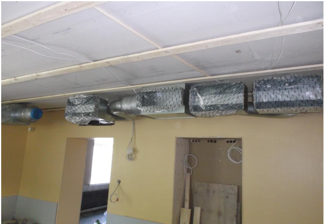
Kuva 9a. Päätelaitteet ennen kotelon asentamista (Kuva Olli Sauvola).
