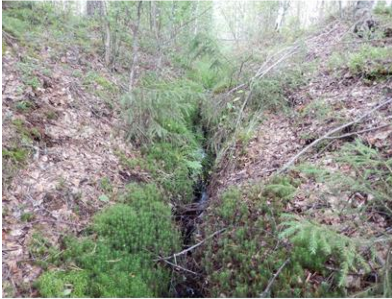
KUVA 2. Vesi on uurtanut uomansa ojan pohjaan (Kuva: Teija Mäkelä 2014)
