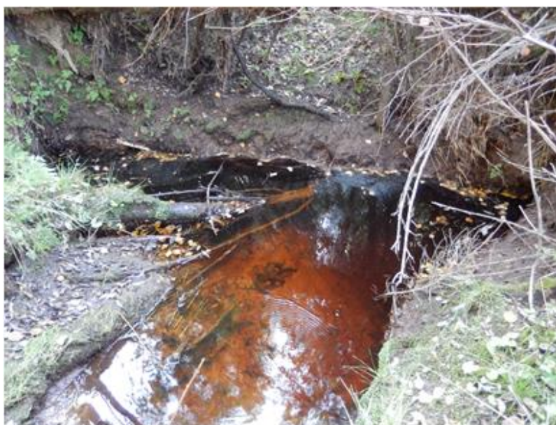
KUVA 5. Painunut ojarumpu uomassa (Kuva: Teija Mäkelä 2014)
