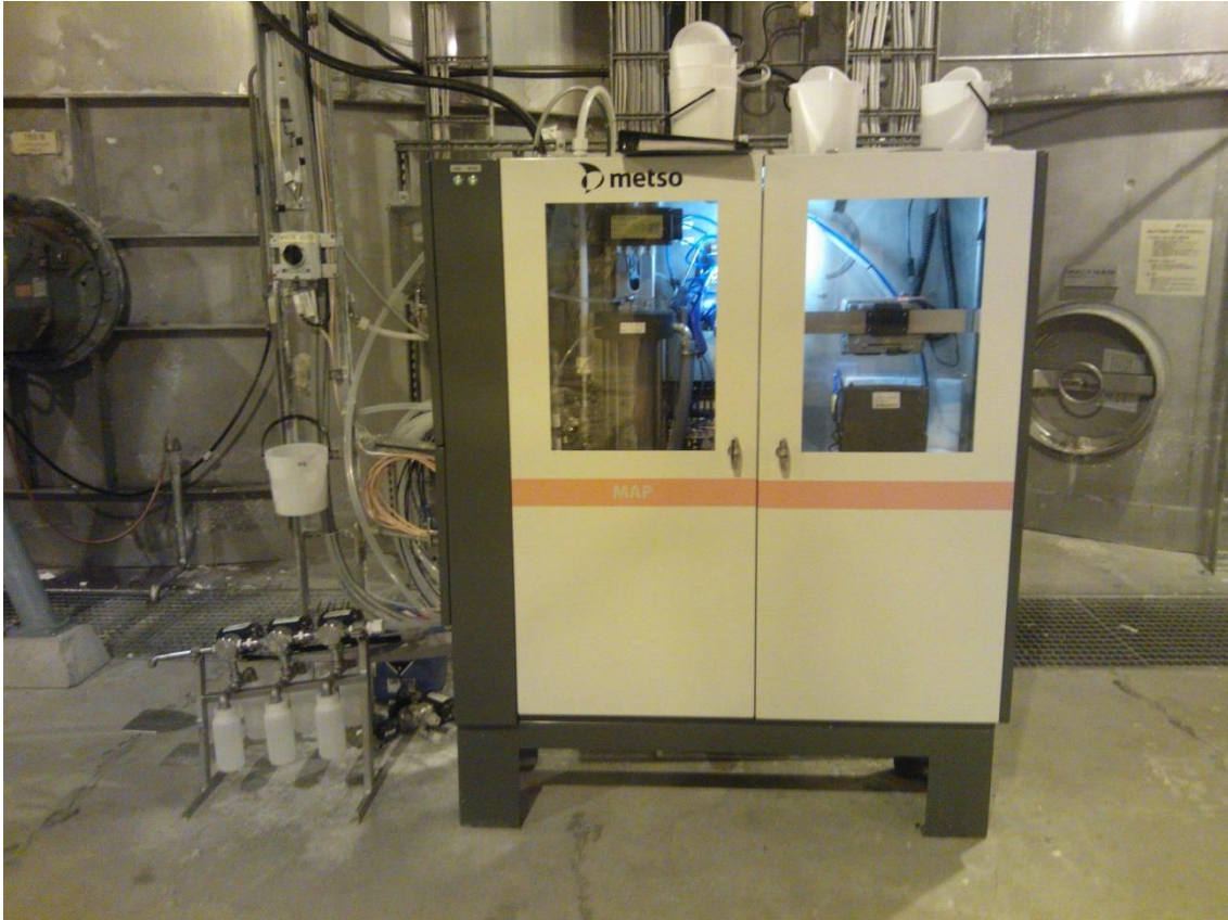
KUVA 11. PK7:n MAP-analysaattori asennettuna käyttöpaikalleen sekoitussäiliön eteen. Analysaattorin vasemmalle puolelle oli lisätty venttiilikoonta, josta paperikoneen käyttäjät hakevat automaatiojärjestelmän käyttöliittymästä valitun käsinäytteen.
