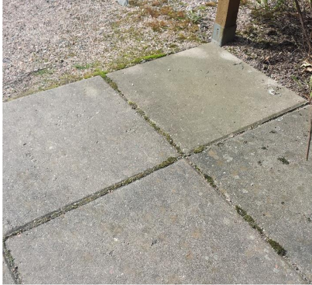
Kuva 2. Betonin pinnalla ja saumoissa on sammalta.
