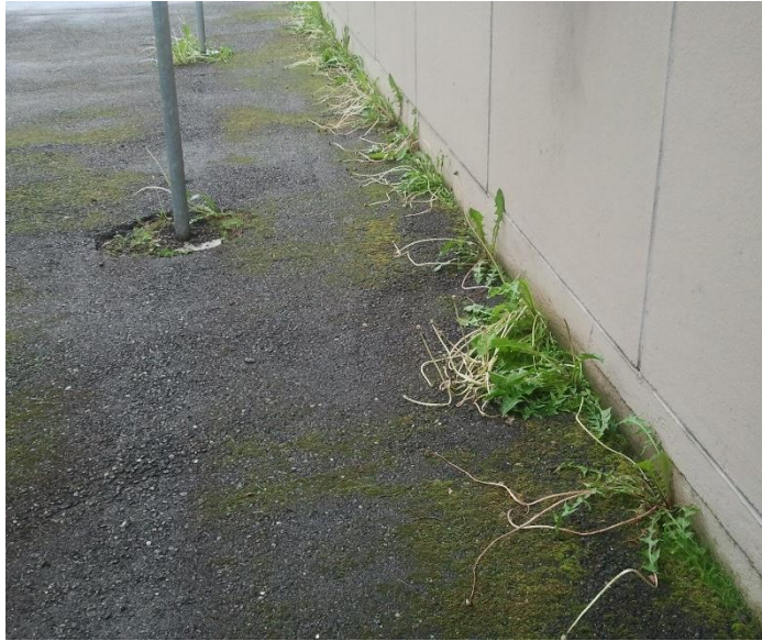
Kuva 3. Rakennuksen seinustat voivat näyttää tältä ennen rikkakasvien poistoa.
