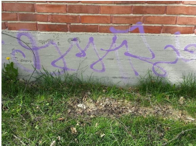
Kuva 5. Graffiteja rakennuksen seinällä.
