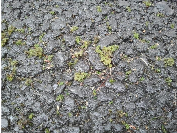
Kuva 1. Sammalta asfaltin raoissa.
