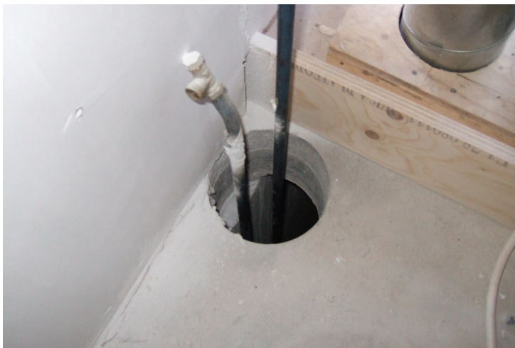
Kuvio 8: Talotekniikkaurakoitsijan merkkäama liian suuri läpivienti (Kuva: Topi Salminen)
