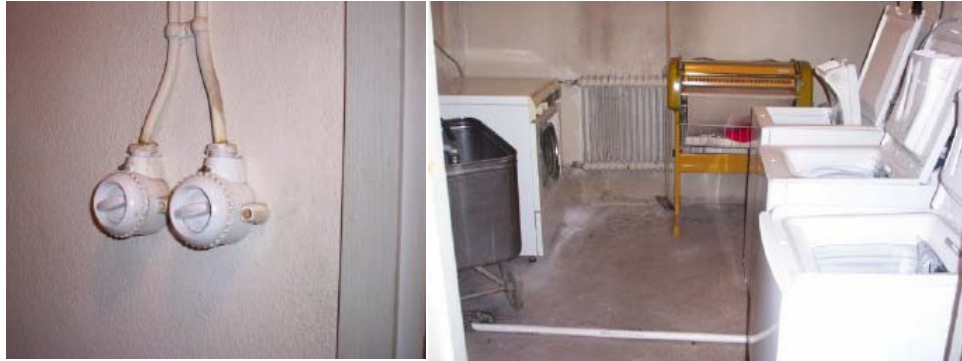
Kuva 17. Pesutuvan kiertokytkimet ja poistoputki
