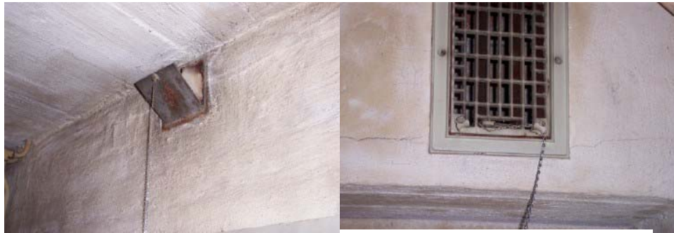
Kuva 26. Kuivaushuoneen korvausilmaluukku ja poistoilmaventtiili.
