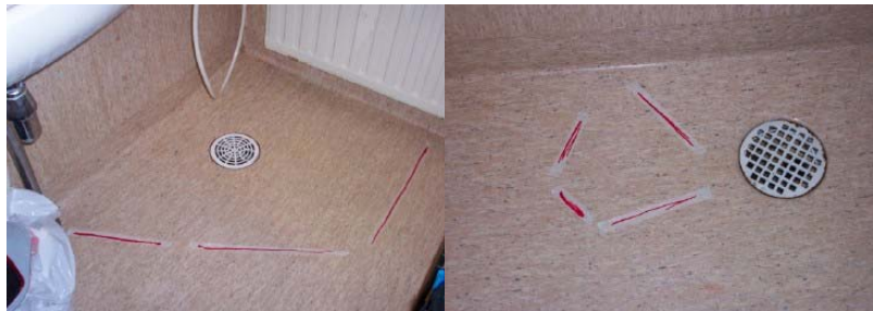
Kuva 20. Asunnon 3 ja 6 muovimatto irti alustastaan
