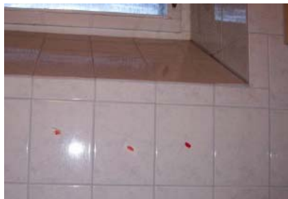
Kuva 16. Irti olevat kaakelit.
