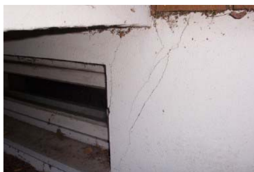
Kuva 13. Porrashuoneen halkeaman kohta ulkopuolelta
