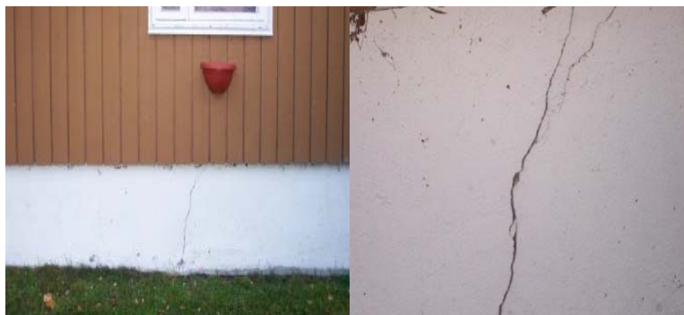
Kuva 1. Halkeama asunnon 3 kohdalla.
