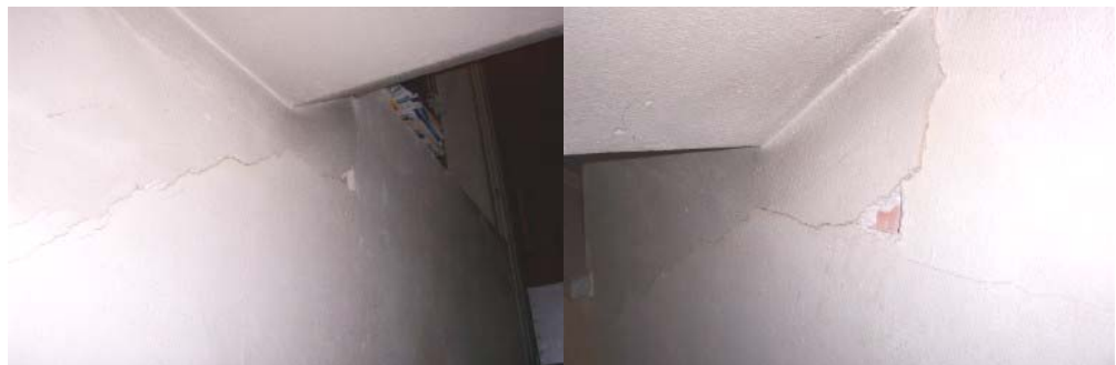
Kuva 12. Porrashuoneen seinän halkeama.
