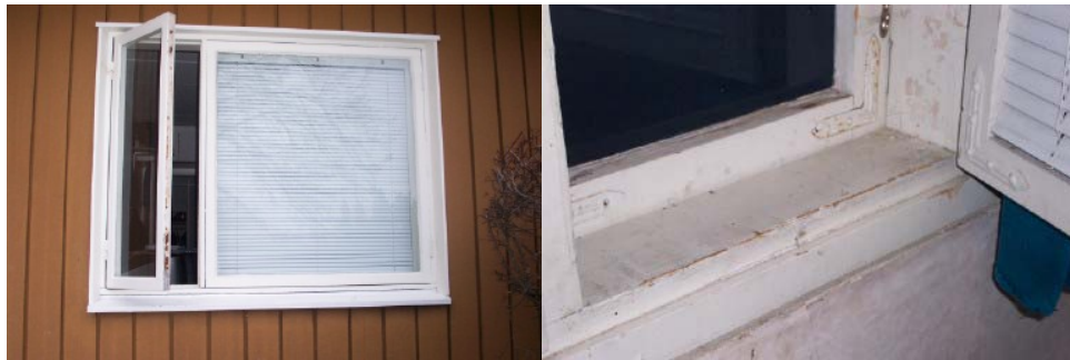
Kuva 9. Ikkuna ja maalin hilseily
