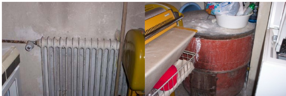
Kuva 18. Pesutuvan lämmityspatteri ja vesipata.
