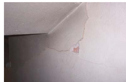
Kuva 3. Kellarin ulkoseinän halkeama.
