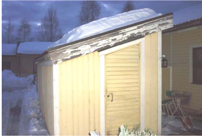
Kuva 11. Lahdenpuisto II C ulkovarasto. Maalipinta on kärsinyt.
