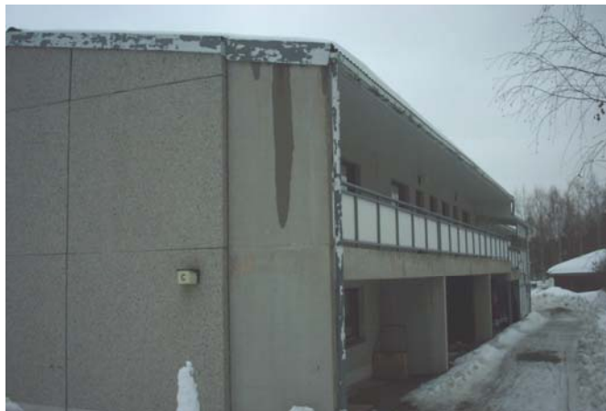
Kuva 8. Salmenkartano C. Maali hilseilee rakennuksen pelti osista.
