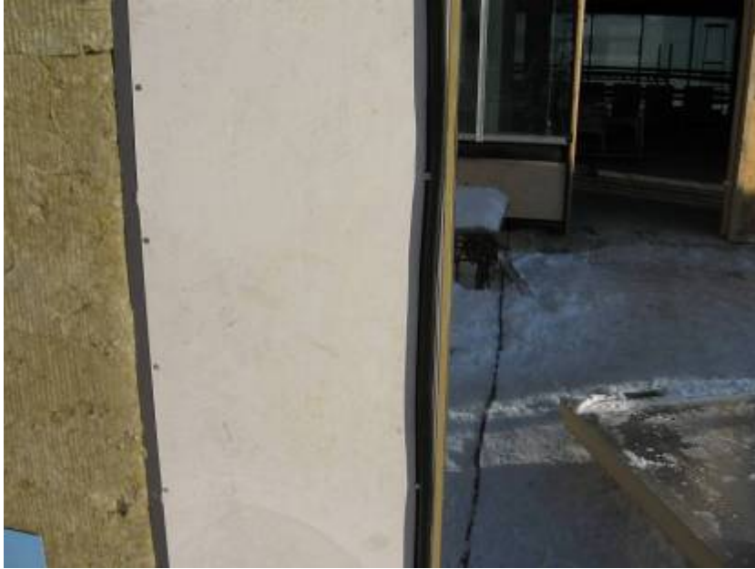
Kuvio 29: Oikeassa reunassa on Tehoranka-elementin ulkopuolen pystysauman kumitiiviste. Seuraava elementti asettuu 90 astetta tiivisteestä ulospäin. (Kuva: Teemu Saari)
