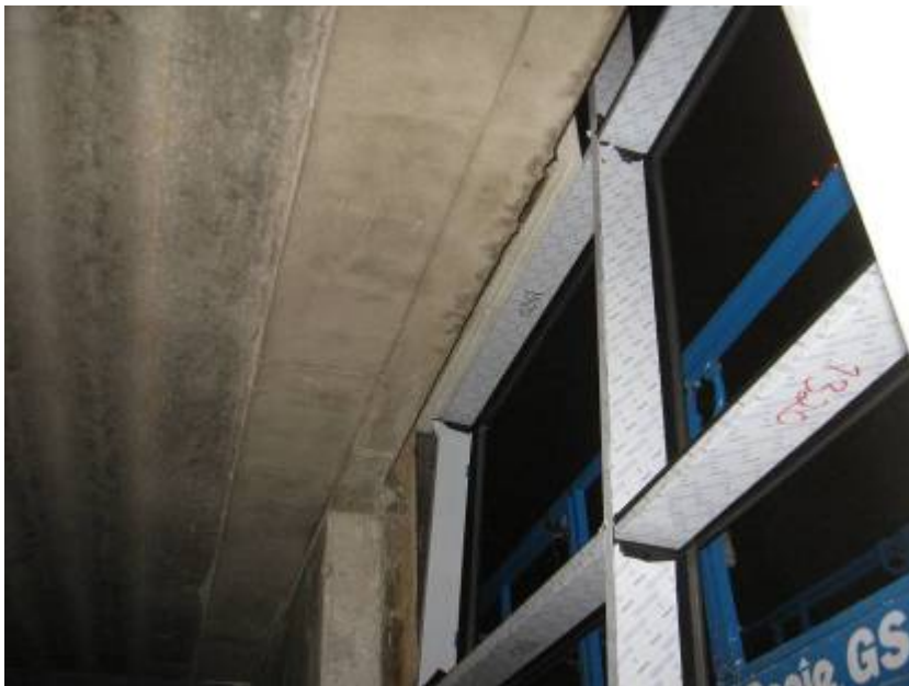
Kuvio 55: Betonisen julkisivuelementin alapää on ollut liian matalalla (Kuva: Teemu Saari)
