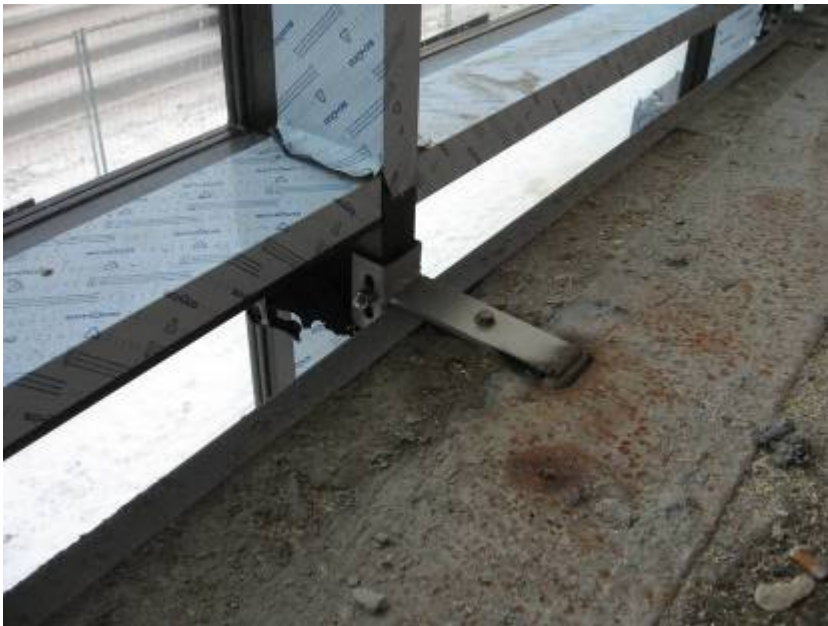
Kuvio 53: Lasiseinän ja välipohjan tiivistys on jäänyt suunnittelematta (Kuva: Teemu Saari)
