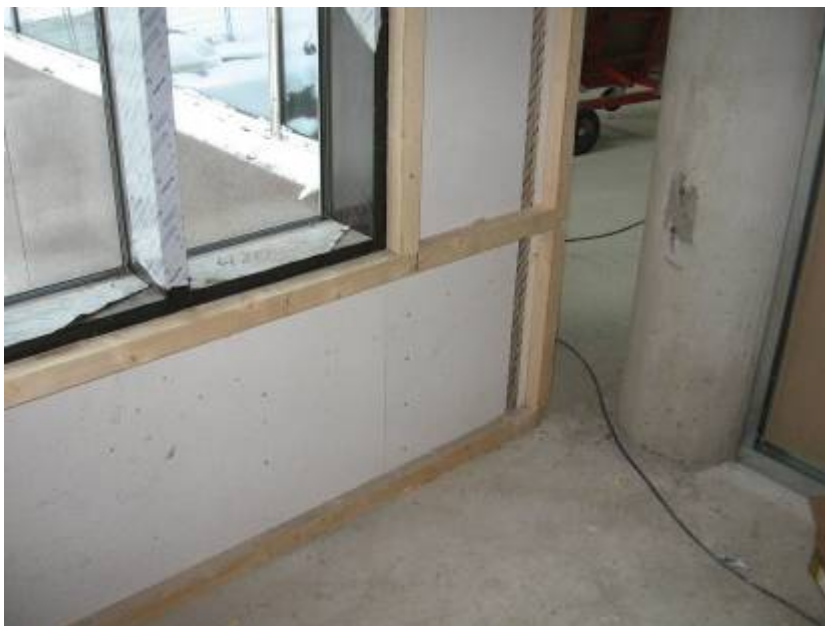
Kuvio 33: 50 mm lisäkoolaus on asennettu työmaalla. Höyrynsulkumateriaalina on pelti. (Kuva: Teemu Saari)
