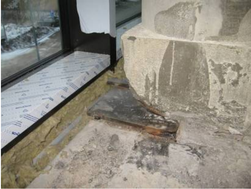
Kuvio 60: Piikkaamisen välttämiseksi olisi suotavaa valmistaa pilarin jatkoskohtiin toisenlainen kiinnike julkisivuelementille (Kuva: Teemu Saari)
