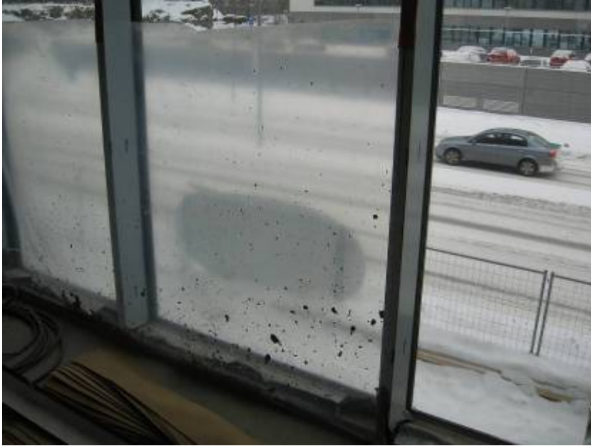
Kuvio 19: Lisäsuojausta. Tuore betoni syövyttää maalatun alumiinin nopeasti (Kuva: Teemu Saari)
