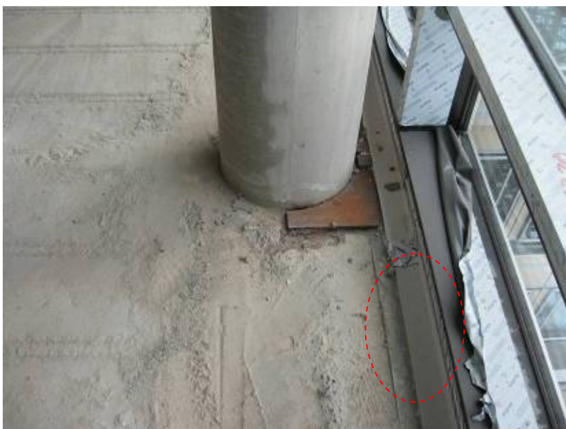
Kuvio 34: Rungon ja julkisivun väliin asennetaan topparipelti lattiavalua varten (Kuva: Teemu Saari)
