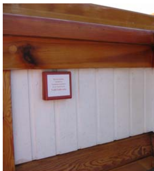
Konehuoneen Softex-järjestelmän laukaisukahva.
