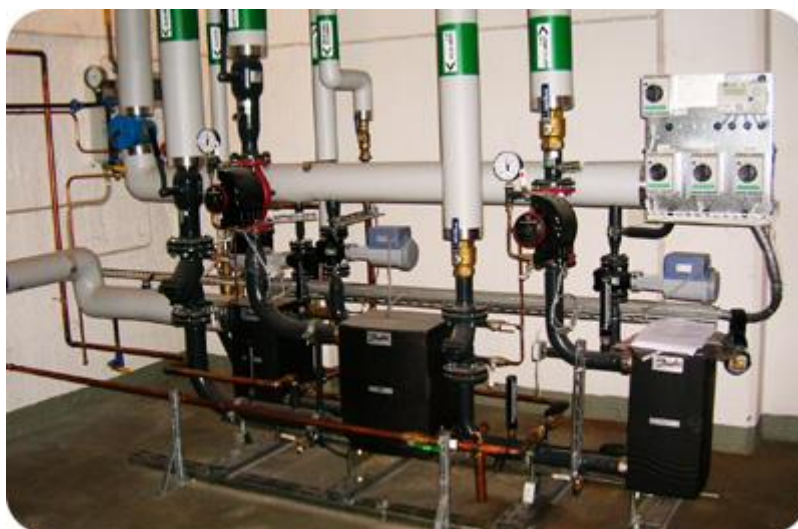
Figur 4: Värmeväxlarpaket med 3 stycken värmeväxlare(4)
