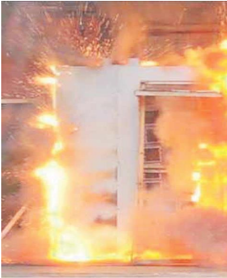
Kuvio 1. Valokaari aiheuttaa tuhoa kojeistossa (Arc flash compliance protecting employees n.d.).
