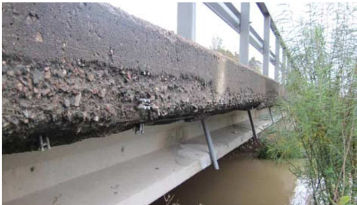
KUVA 4 Vaurioitunut reunapalkki (Ramboll Oy, 2012)
