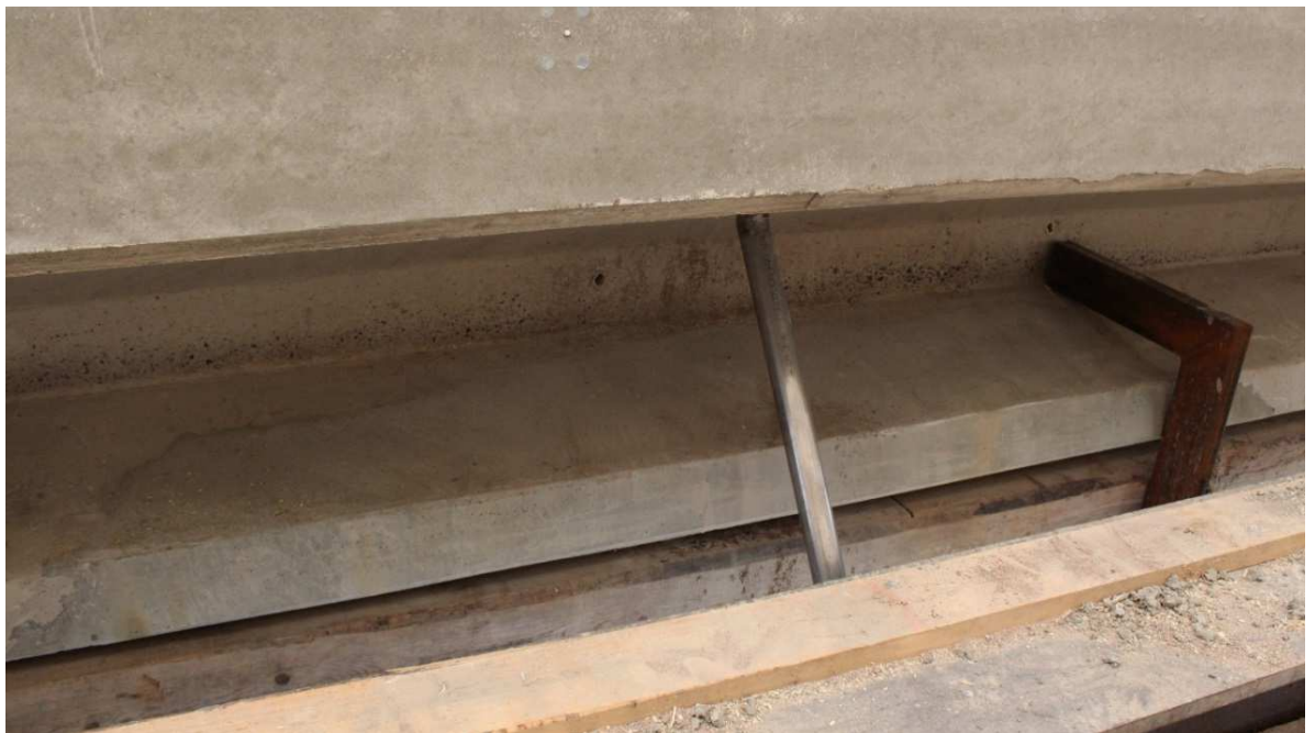
KUVA 16 Juotosbetonilla korjattu kannatinpalkki (Laaksonen Matti, 2013-09-13)
