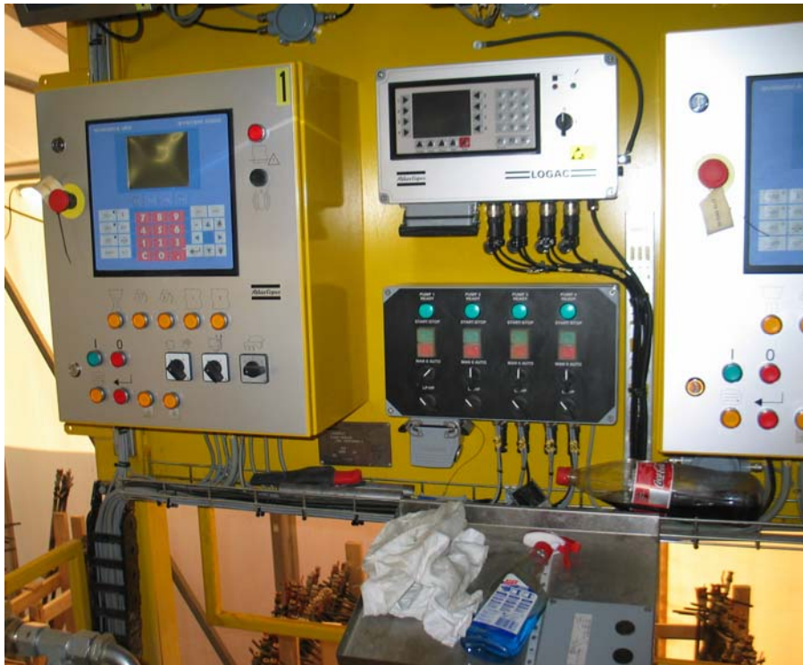
Kuva 17 Massan valmistus ja injektointipaineen sekä – menekin ohjauslaitteet
