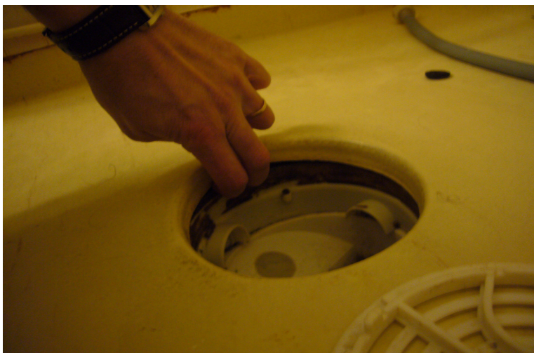
Kuva 1 Lattiapinnoite on irronnut kaivon ympäriltä
