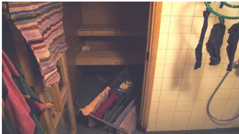
Kuva 7 Pyykkien kuivatus kylpyhuoneessa lisää kosteusrasitusta
