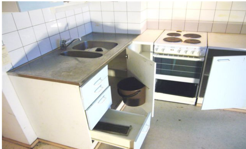
Kuva 11 Työtasot kuluneita ja yleisilme epäsiisti
