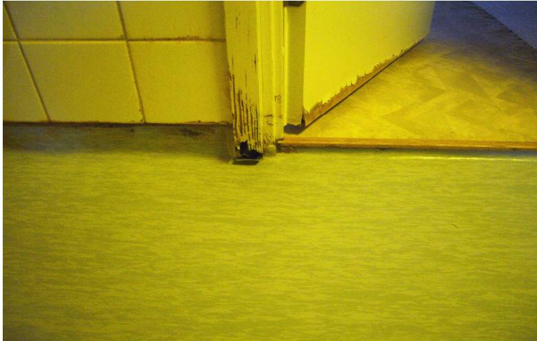
Kuva 4 Oven karmien, listojen ja oven kosteusvauriot
