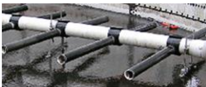
Kuva 6. Putki-ilmastimet ilmastusaltaassa (Hyxo Oy 2015).
