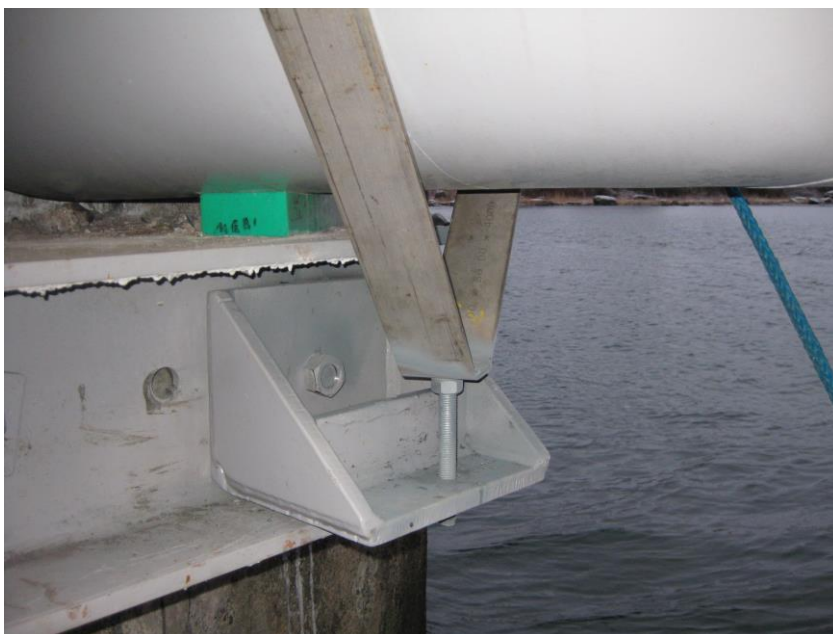
Kuva 21. Kuvassa liikuntalaakeri ja sillan kiinnitys.
