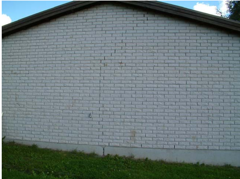
Kuva 3 Haljennut tiilimuraus rakennuksen päädyssä
