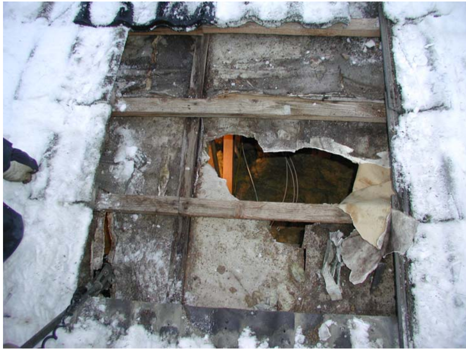
Kuva 2 Vaurioitunutta vesikattorakennetta yhteisten pesutilojen yläpuoleisessa vesikatossa
