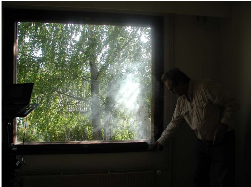
Kuva 2 Ilman vuotokohta sijaitsee tässä asunnossa ikkunan liitoskohdassa.
