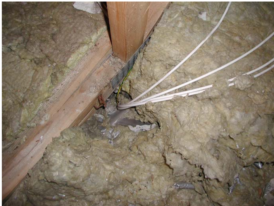
Kuva 4 Lämmöneriste puuttuu pesutilojen yläpuolella kohdasta, jossa kulkevat antennin johdot.
