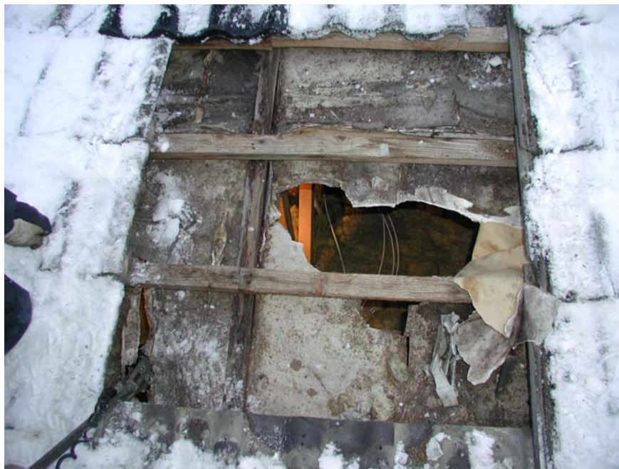
Kuva 11 Vaurioitunut yläpohjarakenne pesutilojen yläpuolella.
