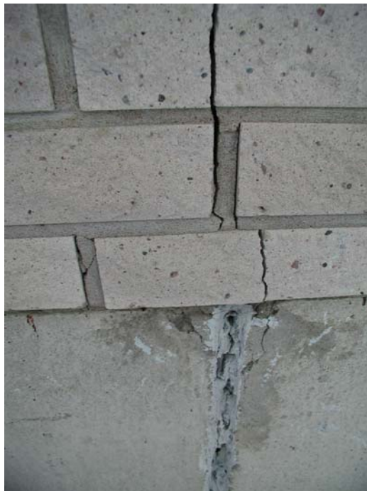
Kuva 4 Lähikuva haljenneesta tiilimuurauksesta.
