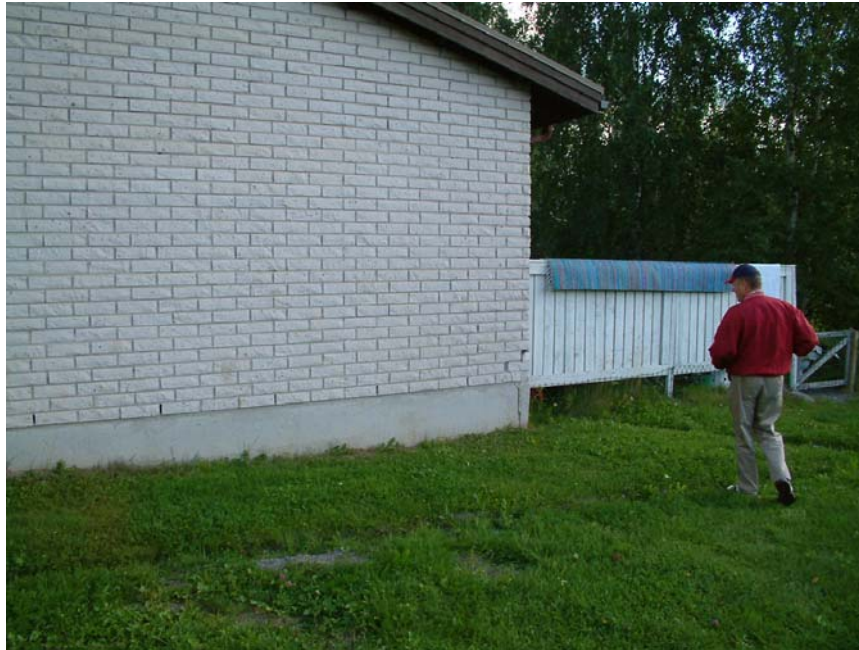
Kuva 5 Sokkelin nurkassa sijaitseva elementtipalanen on selvästi irrallaan.
