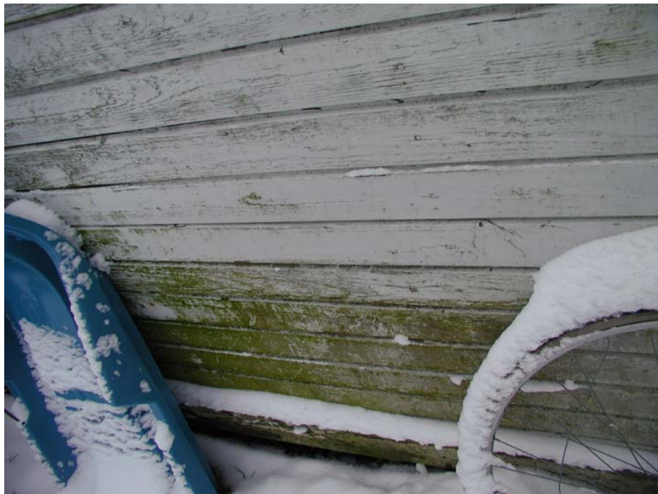
Kuva 10 Ulkovaraston vaurioitunutta maalipintaa
