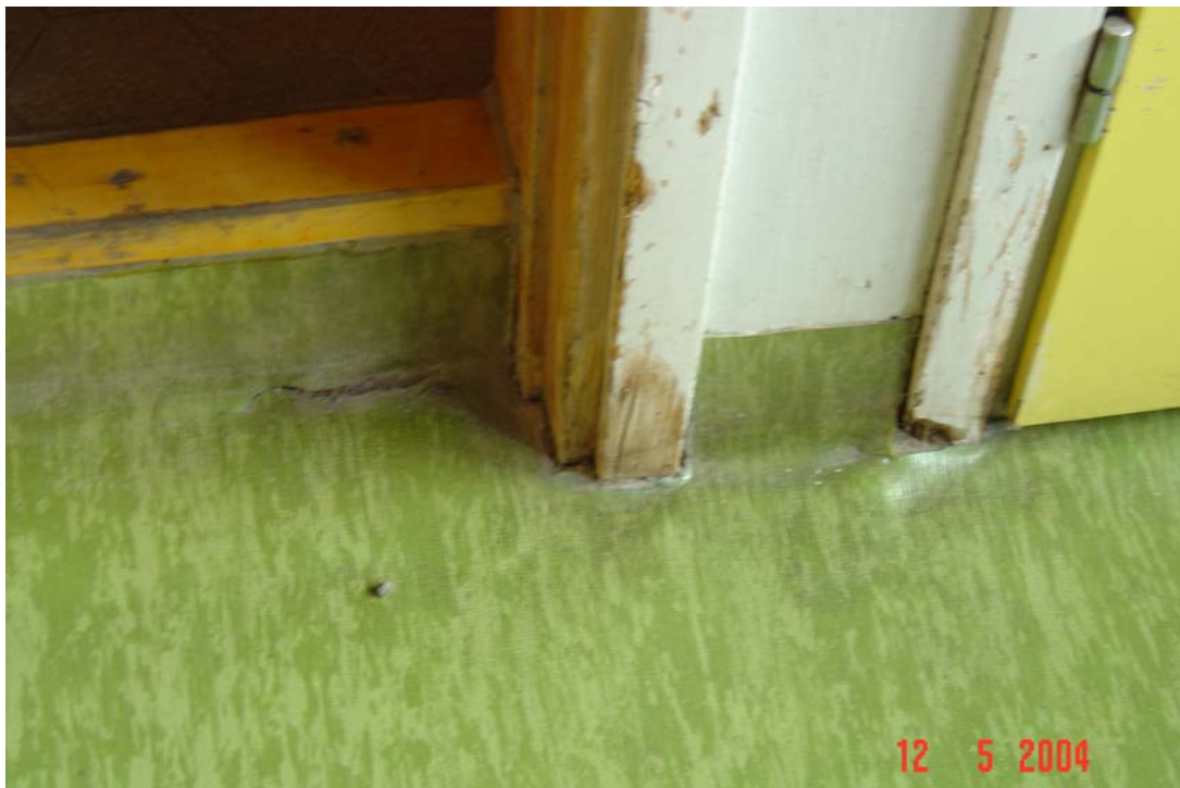
Kuva 14: Miesten pukuhuoneen ja pesuhuoneen välisen oven kynnyks ja karmi ovat kosteuden ja mekaanisen kulutuksen turmelemi
