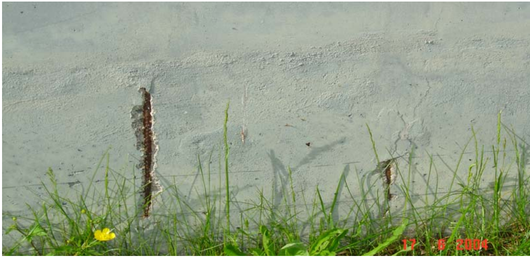
Kuva 10: Lähes olematon suojabetoni sokkelissa – teräkset ruosteessa.
