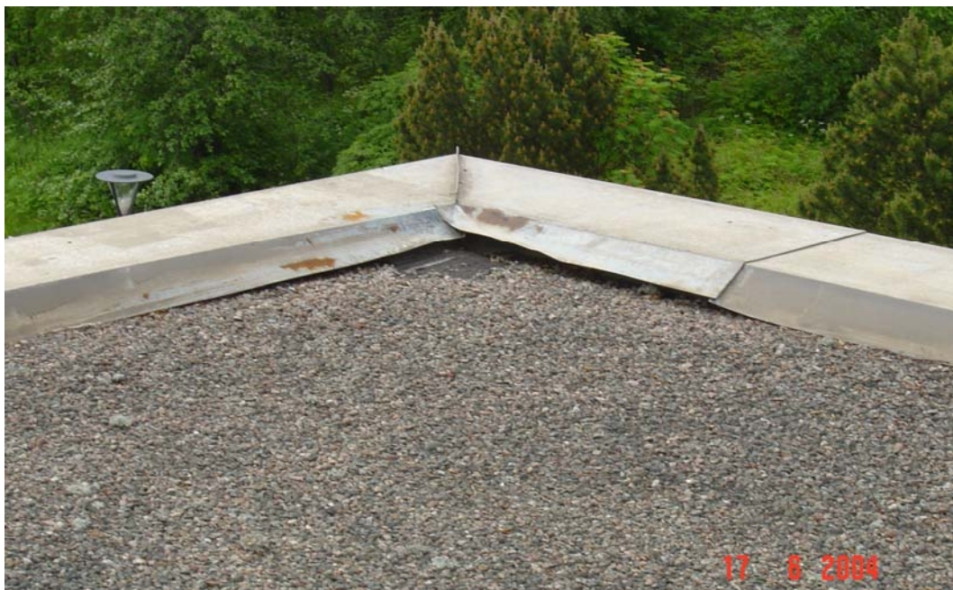
Kuva 9: Rikkinäinen vesikaton reunapelti.
