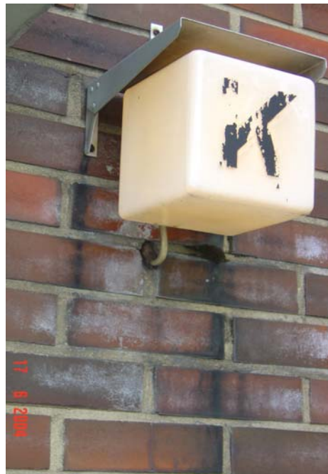
Kuva 12: Virheellinen kaato vesipellissä
