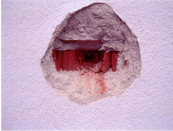
Kuva 1 Pettänyt seinäkiinnitys kennotiessä
