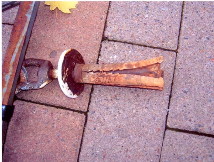
Kuva 2 Seinästä irronnut kiila-ankkuri
