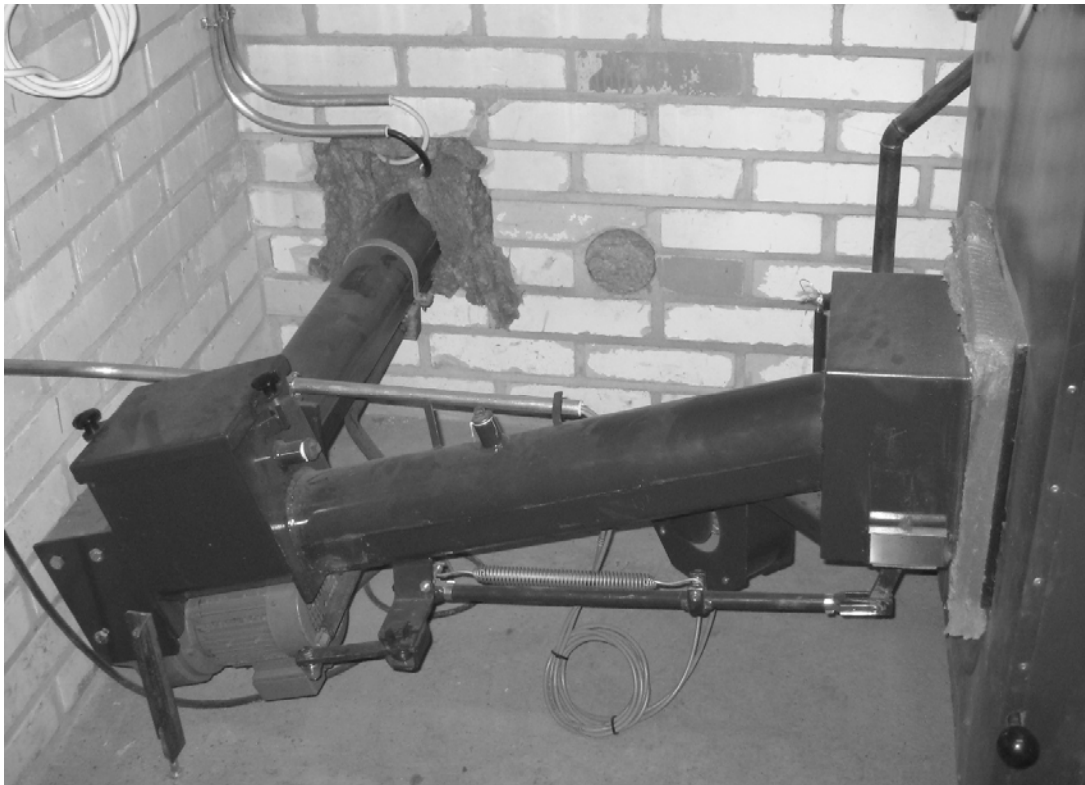
Kuva 1: Logiikkaohjattu, sulkusyöttimellä varustettu etukuormaintäyttöinen hakepoltin.
