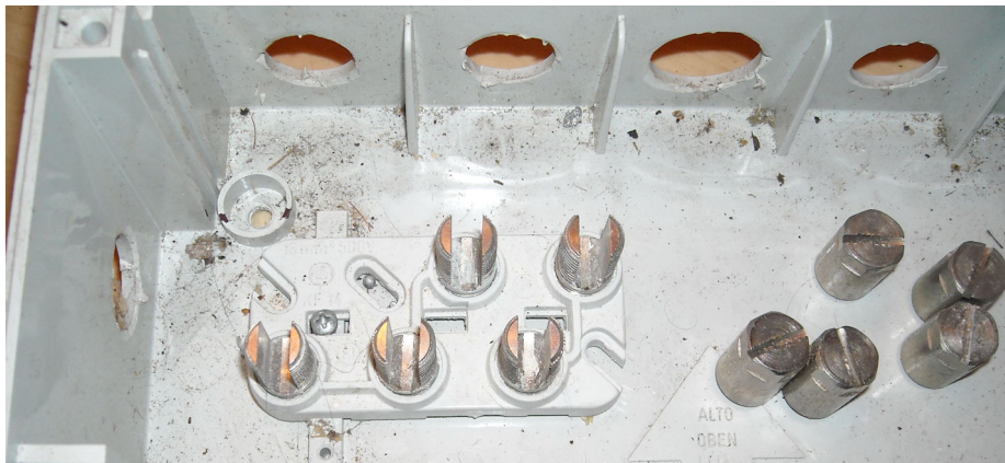
Kuva 45 Generaattorin ja akun johdotuksen kiinnityspiste
