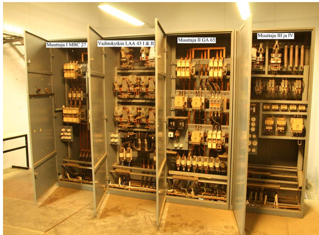
Kuva 20 Muuntajahuoneessa sijaitsevat apulaitekaapit
