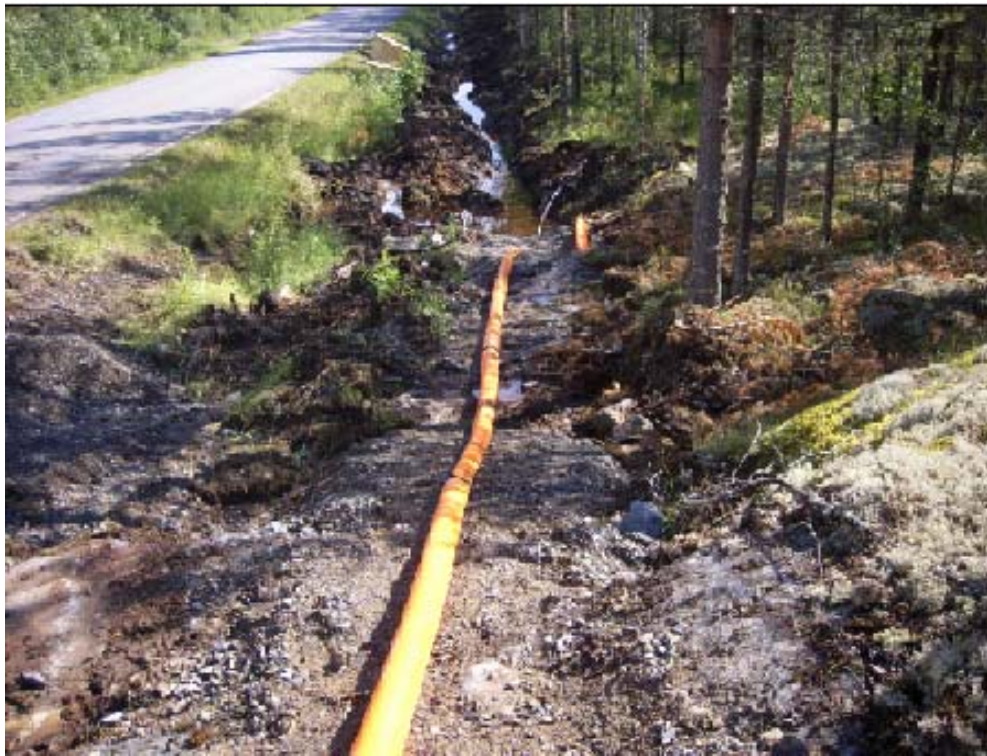
Kuva 4. Kaapeli suojattu halkaistulla putkella
