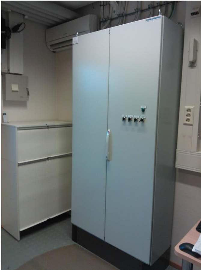
KUVIO 10. Jakokeskus asennettuna tekniseen tilaan.
