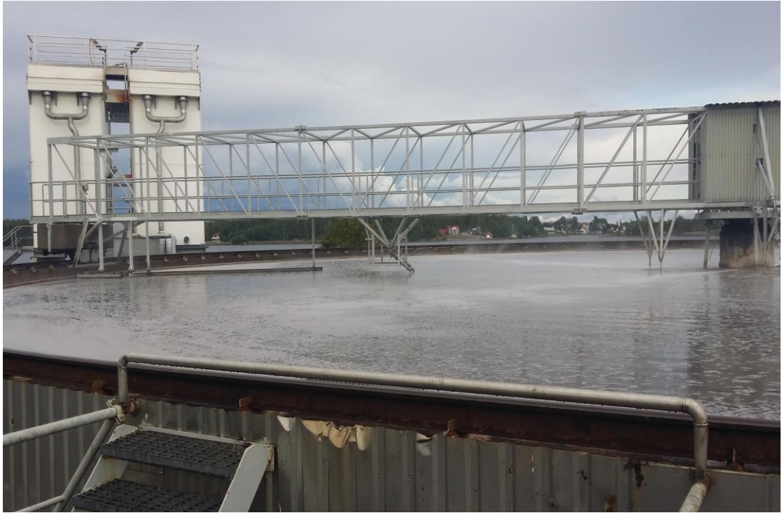
Kuva 3.10. Jälkiselkeytin ja jäähdytystornit.
