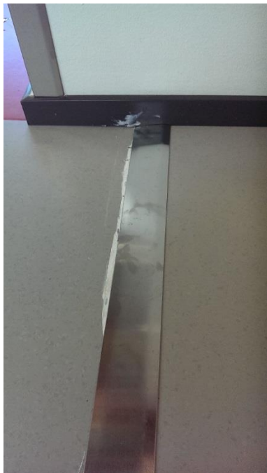
Kuva 1. RST-jynnyksen liimaus on työntekijästä aiheutuva virhe, eikä se täytä hyvää rakentamistapaa. (Kuva: Matias Anttila)
