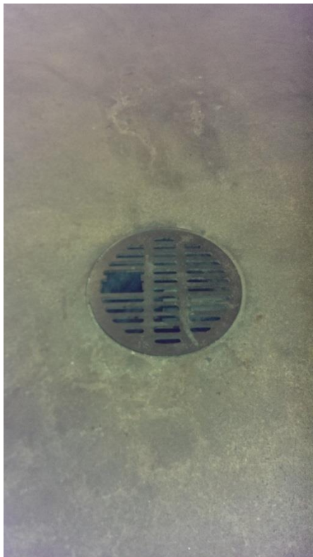
Kuva 7. Kuvan kaivonkansi on suunnitelman mukaan säilyvä, mutta kansi on vaurioitunut joko urakan aikana tai se ollut jo valmiiksi vahingoittunut. (Kuva: Matias Anttila)
