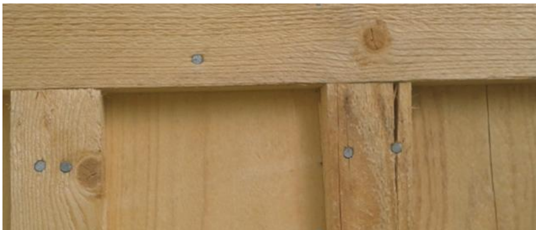
Kuva 23. Virheellisesti toteutettu kiinnitys aiheuttaa rimoissa ja julkisivulaudoissa halkeilua. (Jani Wilhola 2015.)
