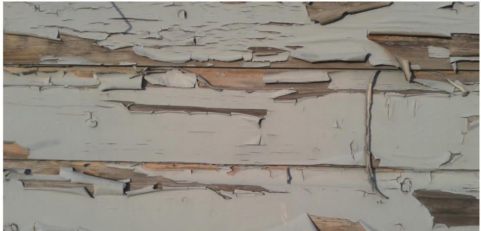
Kuva 26. Isoina lastuina hilseilevä maalipinta on usein merkki siitä, että maalaustyö on suoritettu kostealle tai likaiselle alustalle. (Jani Wilhola 2015.)
