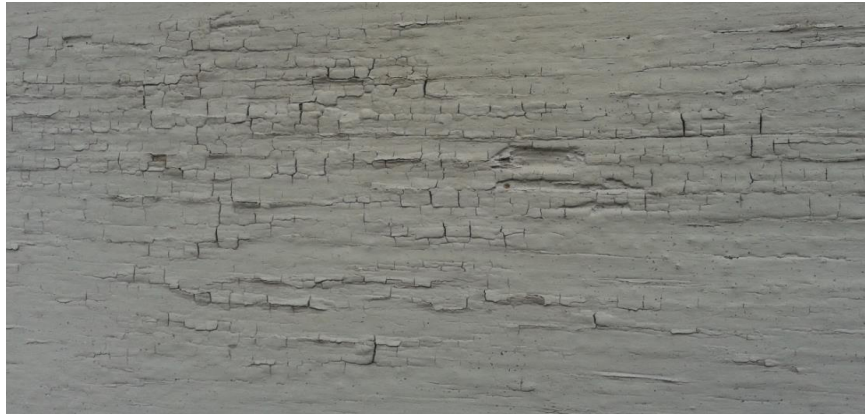
Kuva 28. Virheellinen työsuoritus. Vernissalla pohjustettu puu on kuivunut liian pitkään ja muuttunut lasimaisen kovaksi. Vernissalla kylästetyn, liian pitkään kuivuneen pohjamaalin päällä ei pysy mikään maali. (Jani Wilhola 2015.)
