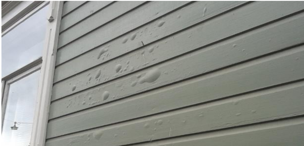
Kuva 30. Varjoisalla pohjoissivulla saattaa esiintyä kosteuskuplia. Kosteuskuplat ovat aiheutuneet liian kosteasta alustasta. (Jani Wilhola 2015.)
