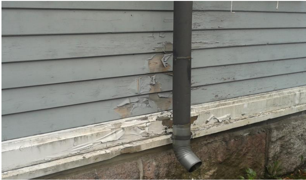
Kuva 11. Syöksytorvi on asennettu virheellisesti saumapuoli seinää vasten. Haljennut saumaus kastelee julkisivua. (Jani Wilhola 2015.)
