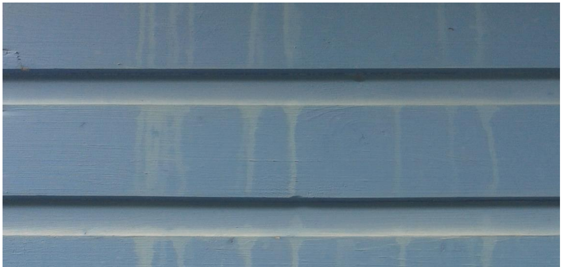
Kuva 57. Puutteellisen työsuorituksen johdosta julkisivupintaan on syntynyt pesuaineen aiheuttamia valumajälkiä. (Jani Wilhola 2015.)
