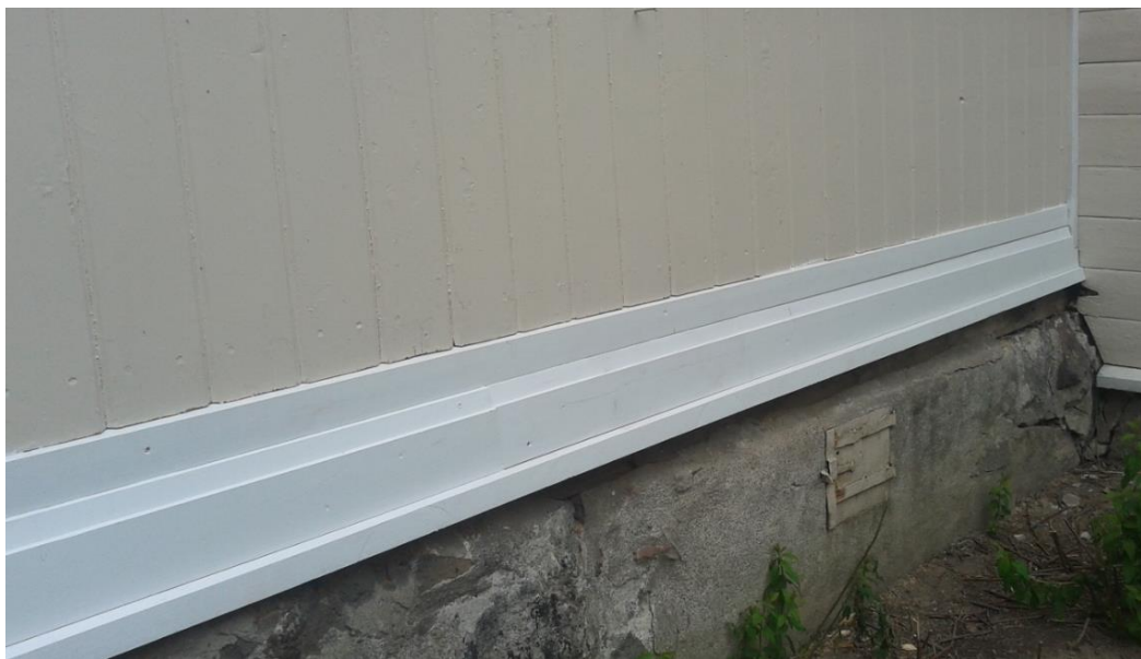
Kuva 18. Pystylaudoituksen alapäiden lahovauriot korjattiin lyhentämällä pystylaudoitusta n. 10 cm, jonka jälkeen vesilistan päälle kiinnitettiin vaakalista. Korjaustavalla kyettiin säästämään mahdollisimman paljon tiukkasyistä, yli sata vuotista julkisivulaudoitusta. (Jani Wilhola 2015.)
