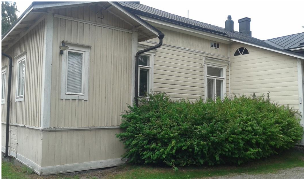
Kuva 16. Julkisivussa kiinni kasvava kasvillisuus lisää julkisivun kosteusrasitusta ja hidastaa kuivumista. (Jani Wilhola 2015.)
