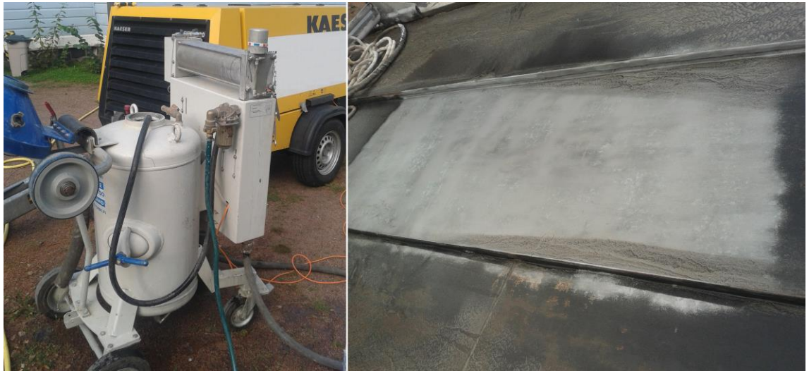
Kuva 40. Märkähiekkapuhalluksesta on ainoastaan hyötyä peltikaton maalinpoistossa. Oikeilla säädöillä ja riittävän hienolla kiviaineskoolla maali saadaan irrotettua sinkkikerrosta säästäen. (Jani Wilhola 2015.)
