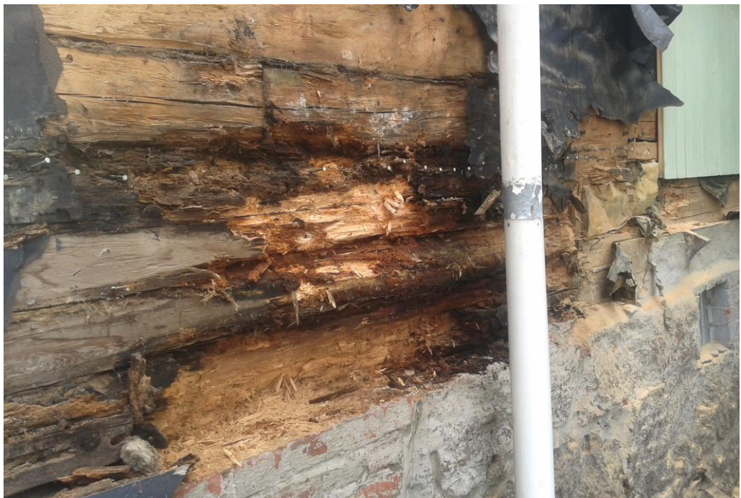
Kuva 12. Syöksytorven puutteellisesti toteutettu jatkos on lisännyt julkisivun kosteusrasitusta aiheuttaen pitkälle kehittyneen home ja lahovaurion. (Jani Wilhola 2015.)
