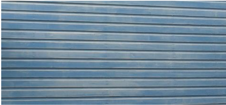
Kuva 37. Eteläisen julkisivun alkydiöljymaalipinnassa on havaittavissa selkeää maalipinnan haalistumista. (Jani Wilhola 2015.)
