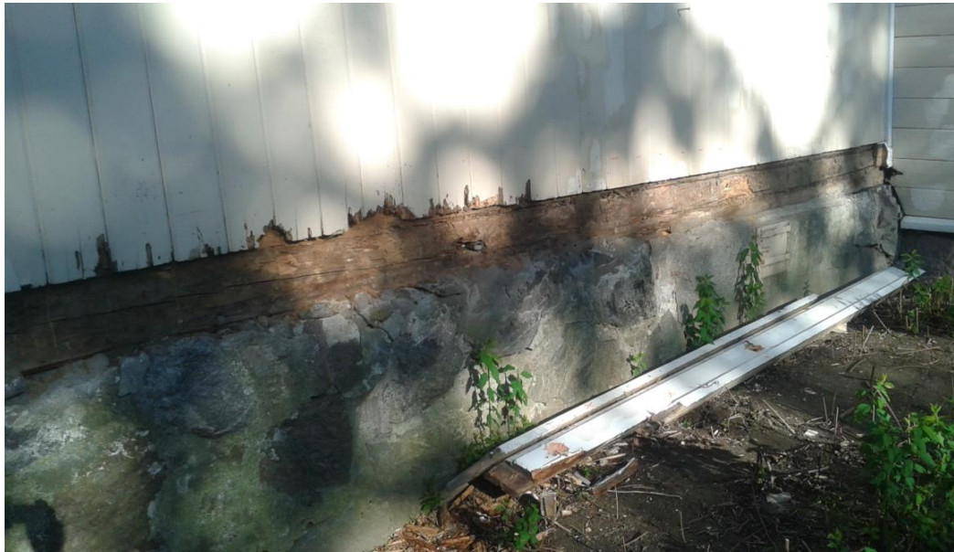
Kuva 17. Ylemmän kuvan kasvillisuuden aiheuttama lahovaurio. (Jani Wilhola 2015.)
