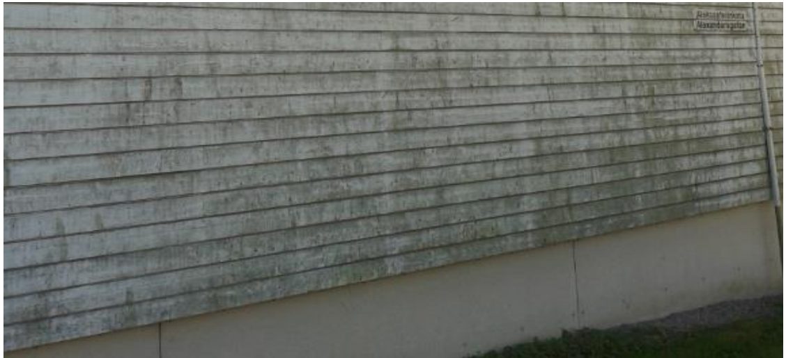
Kuva 34. Varjoisalla pohjoisjulkisivulla on silmin havaittavaa leväkasvustoa. (Jani Wilhola 2015.)
