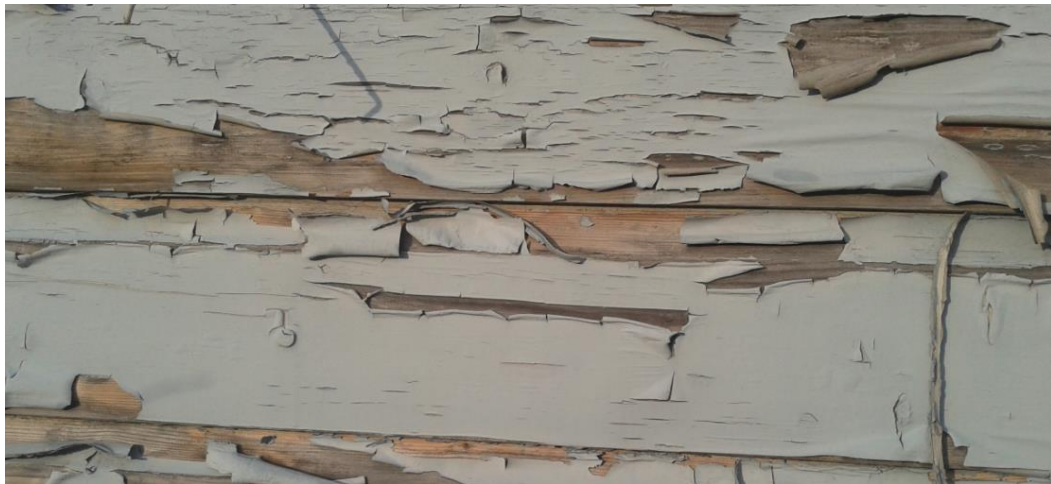
Kuva 60. Maalipinnan hilseily on erityisen voimakasta, jonka seurauksena korjausmaalaukseen on perusteltu työmenetelmä. (Jani Wilhola 2015.)
