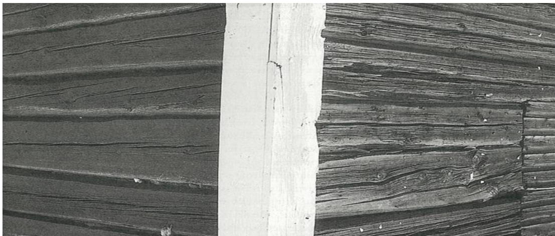
Kuva 2. Varjon puoleinen hirsiseinä on säilynyt kunnossa, kun taas etelään suuntautuvassa seinässä on havaittavissa hirren säröytymistä (1,298)
