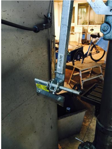
Kuva 8 Aiemmin asennettu suojain on mennyt käytössä rikki.
