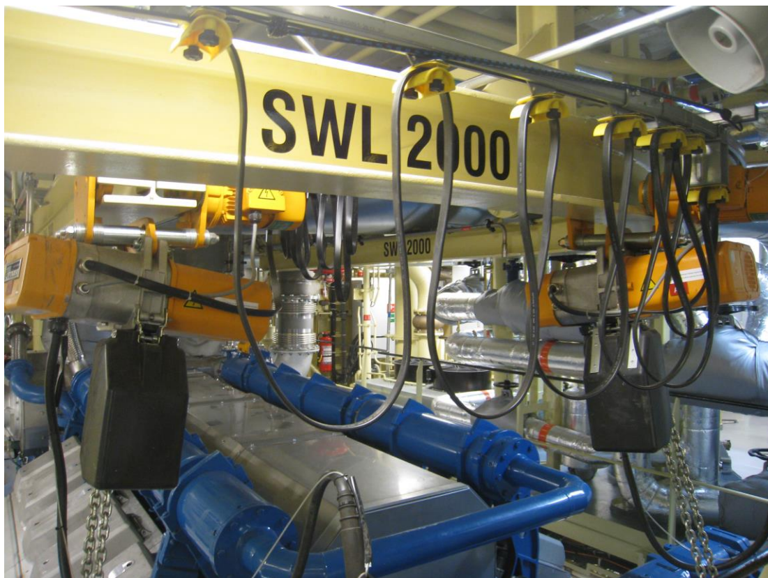
Kuva 49. Konehuoneessa sijaitsevia teollisuusnostureita. (Rajavartiolaitos 2016)
