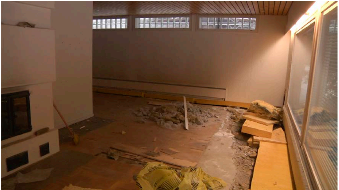
KUVA 3. Rakennusvirheen vuoksi Honkien talo oli homeessa kaikkia rakenteita myöten.
