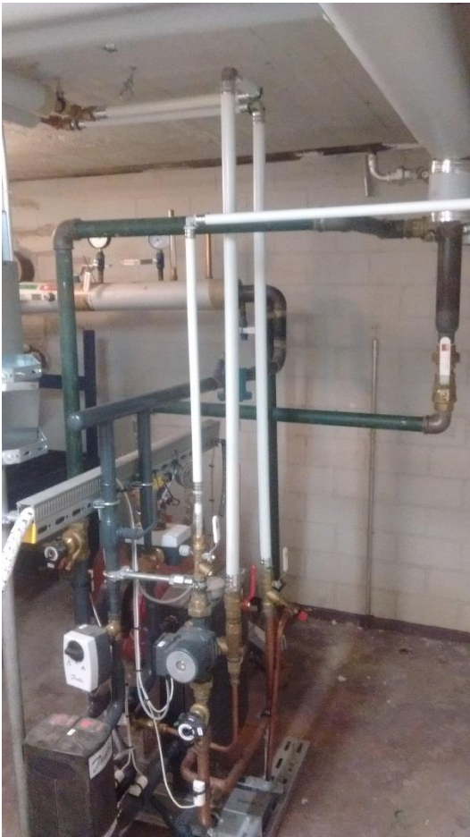
KUVA 16. Malliesimerkki kesken jääneestä eristystyöstä
