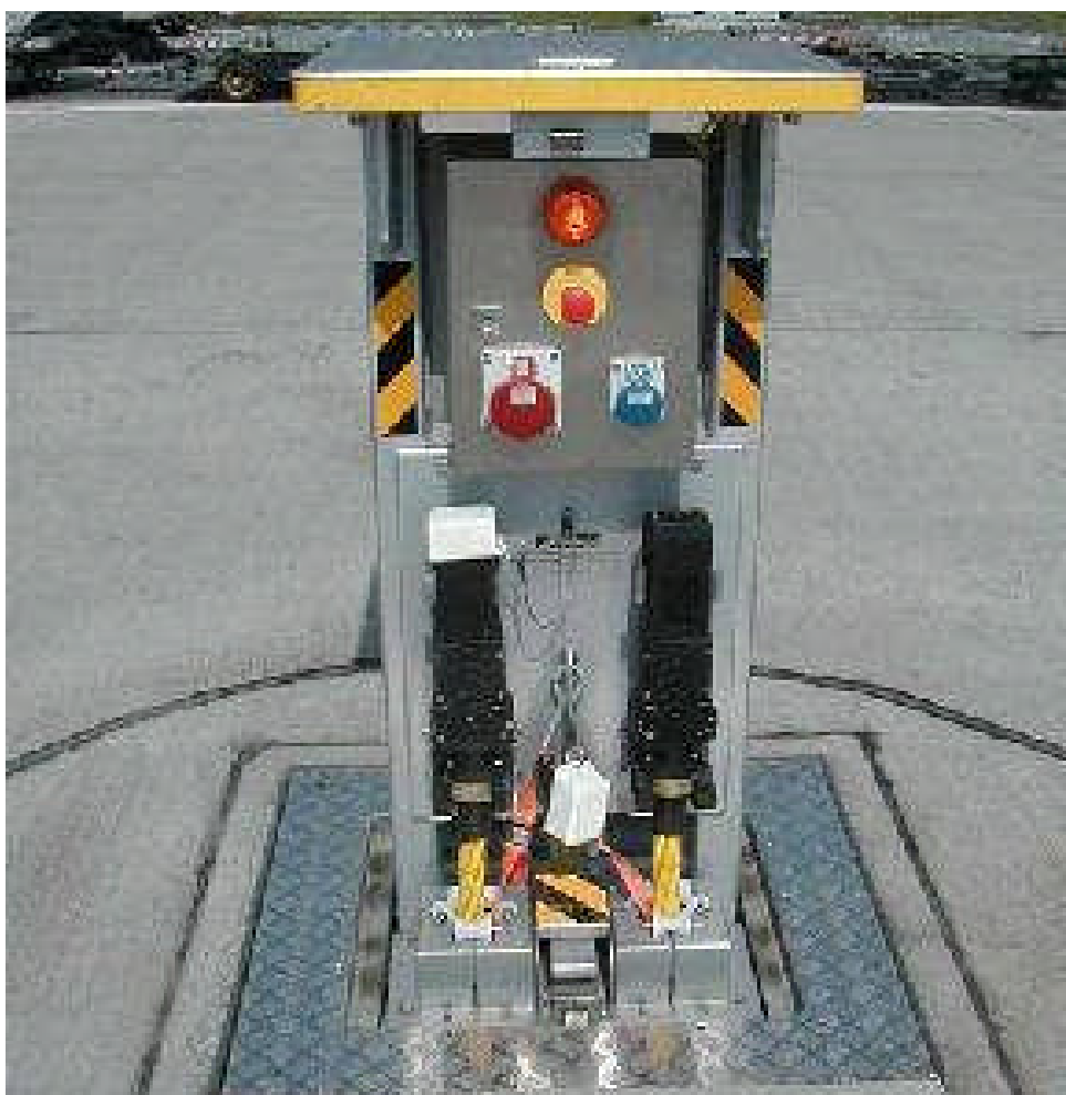
Figur 13. "Pit pop-up"-system med 2 st. flygplansmatningar, 1 st. 230 V trefas-uttag och 1 st. 230 V enfas-uttag
