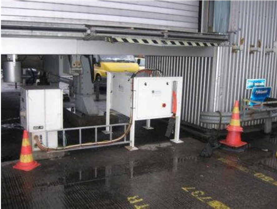
Figur 9. "Mini-Coil" installerad under en passagerarbrygga
