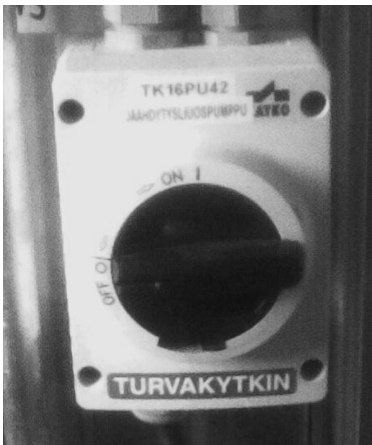
Kuva 2. Uusi turvakytkin ja uudet laitemerkinnät
