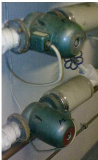
Kuvio 7. Lämmitysjärjestelmän kiertovesipumput (Kuva: Niko Puranen 2011)
