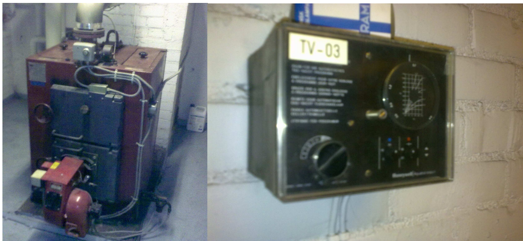
Kuvio 6. Öljykattila ja -poltin sekä lämmitysjärjestelmän säädin (Kuva: Niko Puranen 2011)
