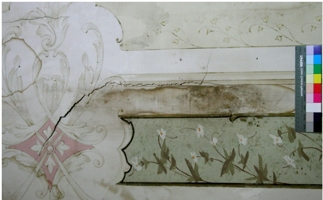
Kuva 6. Sekä juuttikangas että paperointi ovat revenneet katon kaakkoispäädyssä noin 70 cm matkalta. Vaurion syy on todennäköisesti kosteudesta johtuva materiaalien eläminen. (Junnola, 2011.)
