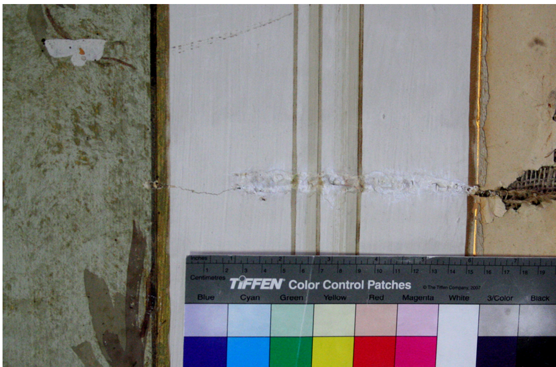
Kuva 6. Viiltomainen reikä taustoitettiin juuttikankaalla, joka kiinnitettiin injektoimalla akryylidisper-sioliimaa. Paperoinnissa oleva reikä täytettiin liisterikitillä, joka sävytettiin taustansa sopivaksi. (Junnola, 2011.)
