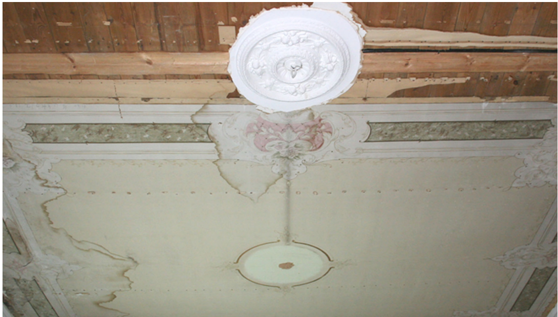
Kuva 6. Vesivaurioitunut alue salin ovelta, eli tilan kaakkoispäädystä kuvattuna. (Junnola, 2011.)
