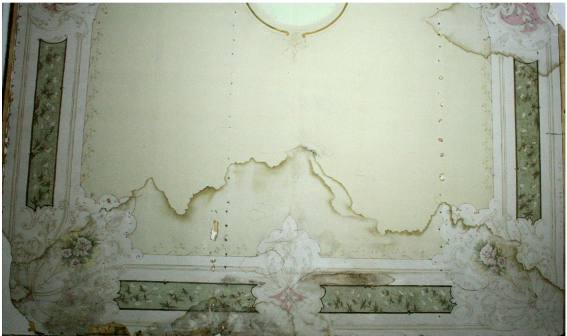
Kuva 10. Kaakkoispään kosteusvaurioitunut alue. (Junnola, 2011.)
