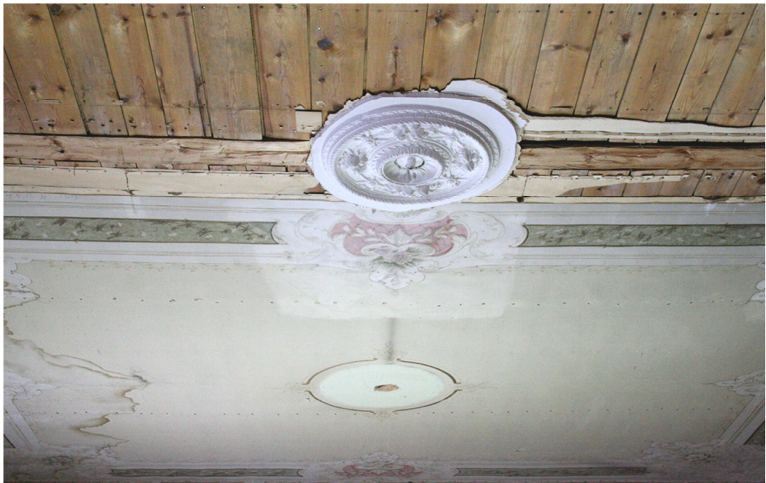
Kuva 7. Tästä katselu suunnasta retusoinnit eivät erotu taustasta juuri lainkaan. Katselusuunnalla onkin suuri merkitys retusoinnin onnistumiseen, ja tämän takia kattopinta on erittäin haastava retusoitava. (Junnola, 2011.)
