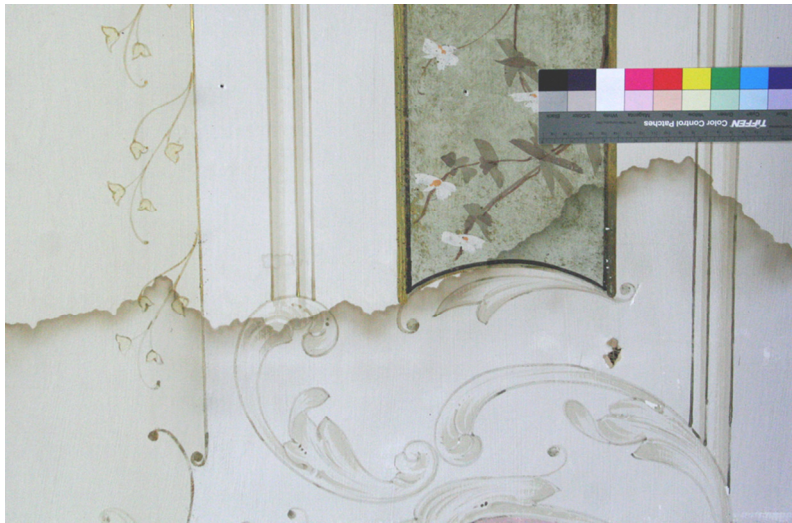
Kuva 1. Yksityiskohta vesivauriosta ennen toimenpiteitä. (Junnola, 2011.)
