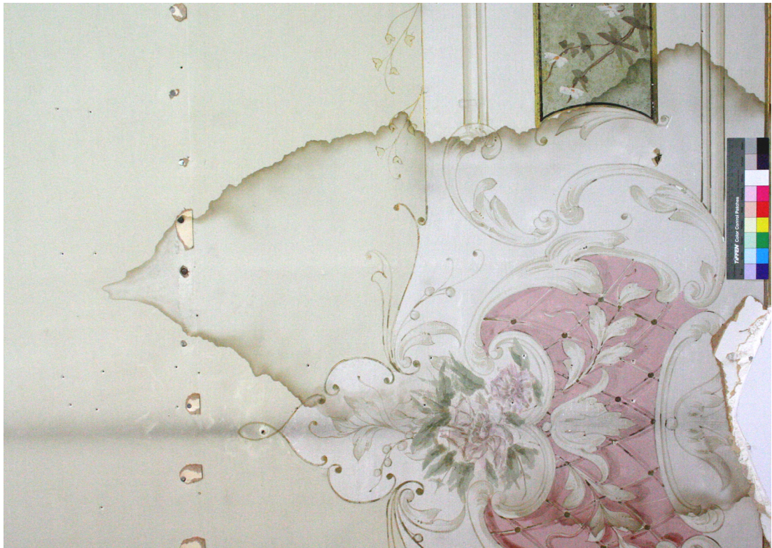
Kuva 4. Katon koillisreunalla oleva vesivaurioitunut alue ennen toimenpiteitä. (Junnola, 2011.)
