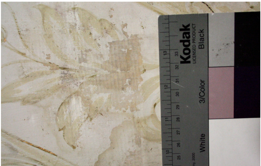
Kuva 12. Maalipinta on liituntunut vesivaurioituneilla alueilla ja irtoaa alustastaan. Maalikerroksen ohentumisen takia juuttikankaan tekstuuri kuultaa paperoinnin läpi. (Junnola, 2011.)
