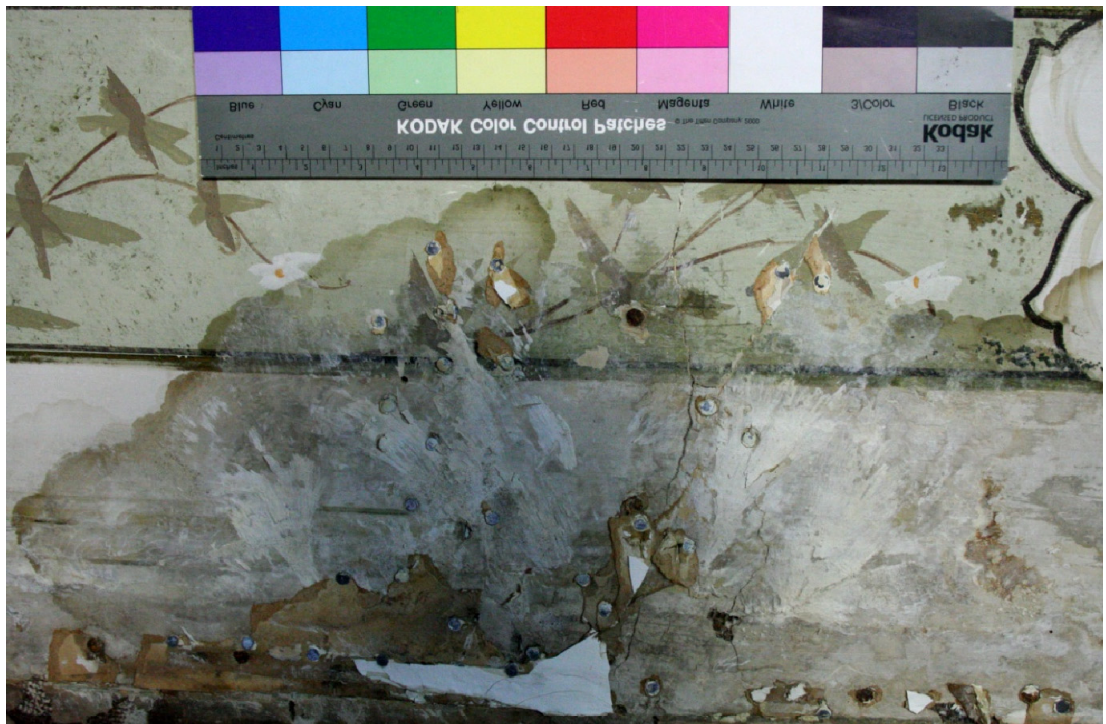
Kuva 8. Vesivaurioituneella alueella on myös sienimäistä kasvustoa. (Junnola, 2011.)
