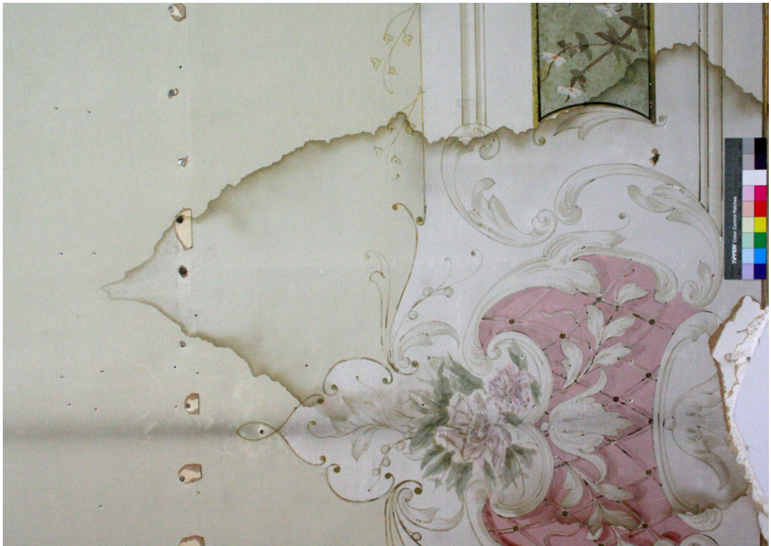
Kuva 11. Toinen vesivaurio katon koillisreunalla. (Junnola, 2011.)
