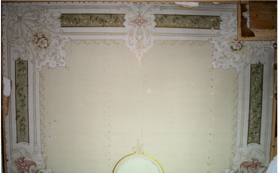
Kuva 1. Katon luoteispääty, jossa vaurioita on vähiten. (Junnola, 2011.)
