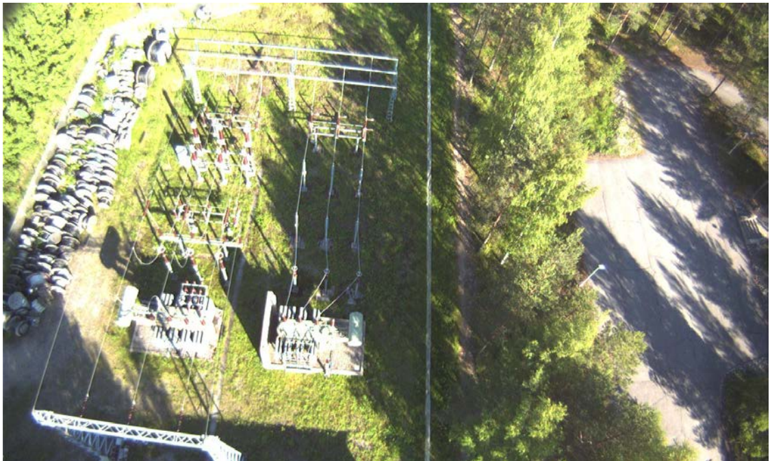
KUVIO 5. Vääksyn sähköaseman ilmakuva
