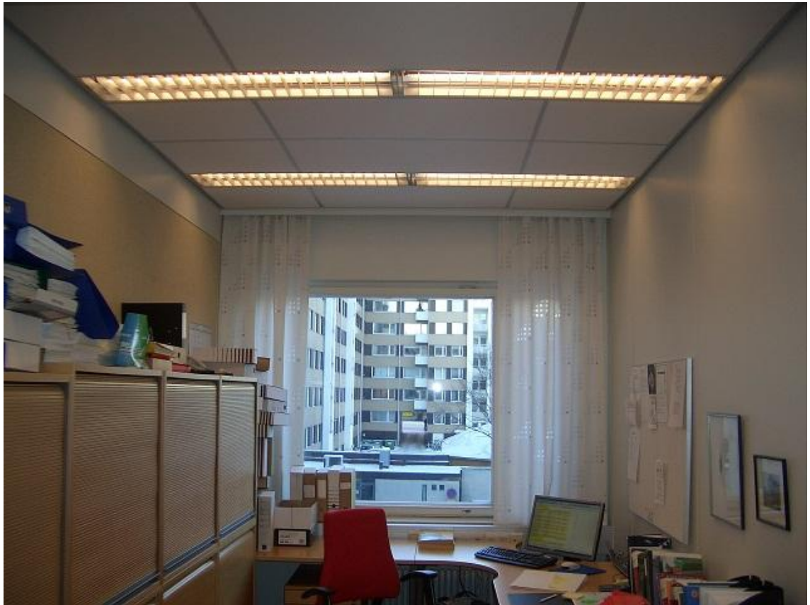
KUVA 5. Toimistohuone, jossa on käytössä vanha valaistusjärjestelmä.
