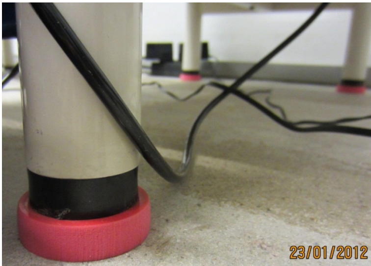
KUVA 28. Sylodynillä toteutettu optimaalinen herkän laitteen nelipistetärinäeristys mittauspisteessä MP3.
