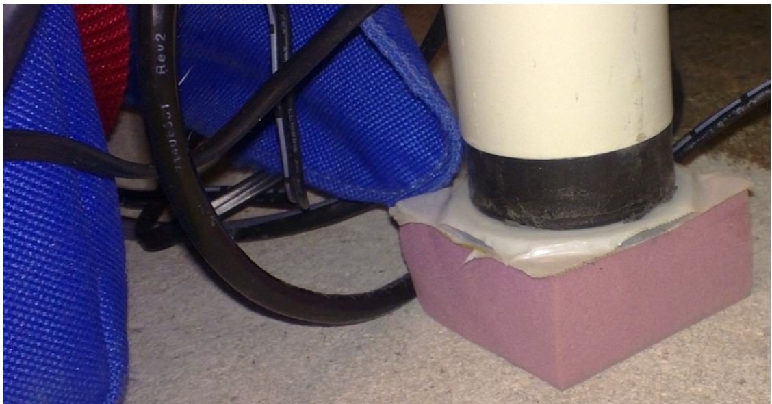
KUVA 36. Optimaalinen Sylomerilla toteutettu värinäeristys. Jalan ja eristeen välissä halkaisijaltaan 50 mm metallilevy.
