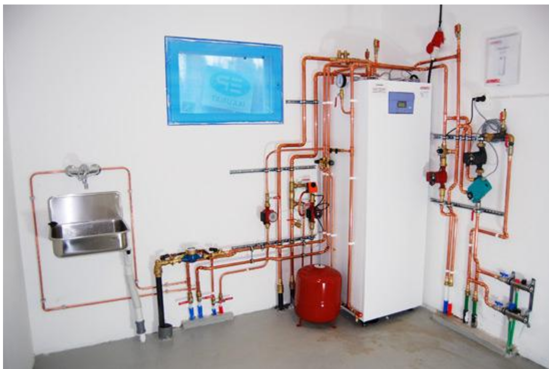
Kuva 10. maalämpöpumppu ja integroituvaraaja (Gebwell)
