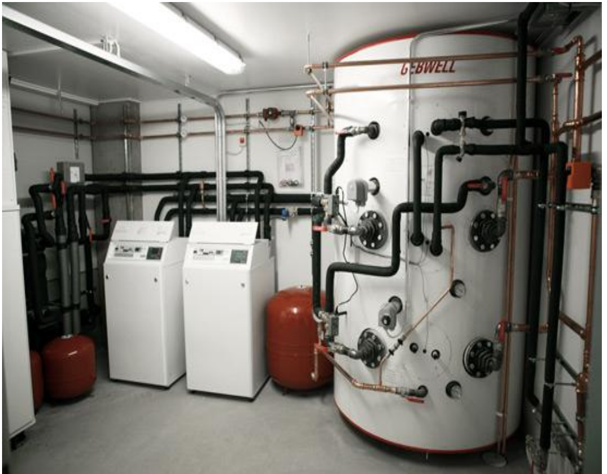
Kuva 11. Hallin lämmitykseen soveltuva maalämpölaitteisto
