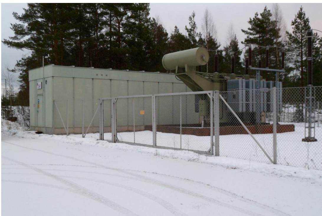
Kuva 6. Lapin aseman yleiskuva ja päämuuntaja
