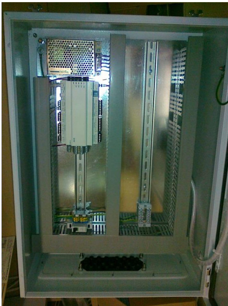
KUVA 2. Metallikoteloon tehty valvonta-alakeskus. (Valokuva Pasi Partanen)
