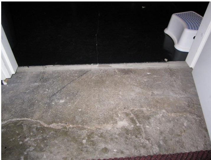
Kuva 24. Eteisen lattian ja wc:n lattian värit eroavat toisistaan
