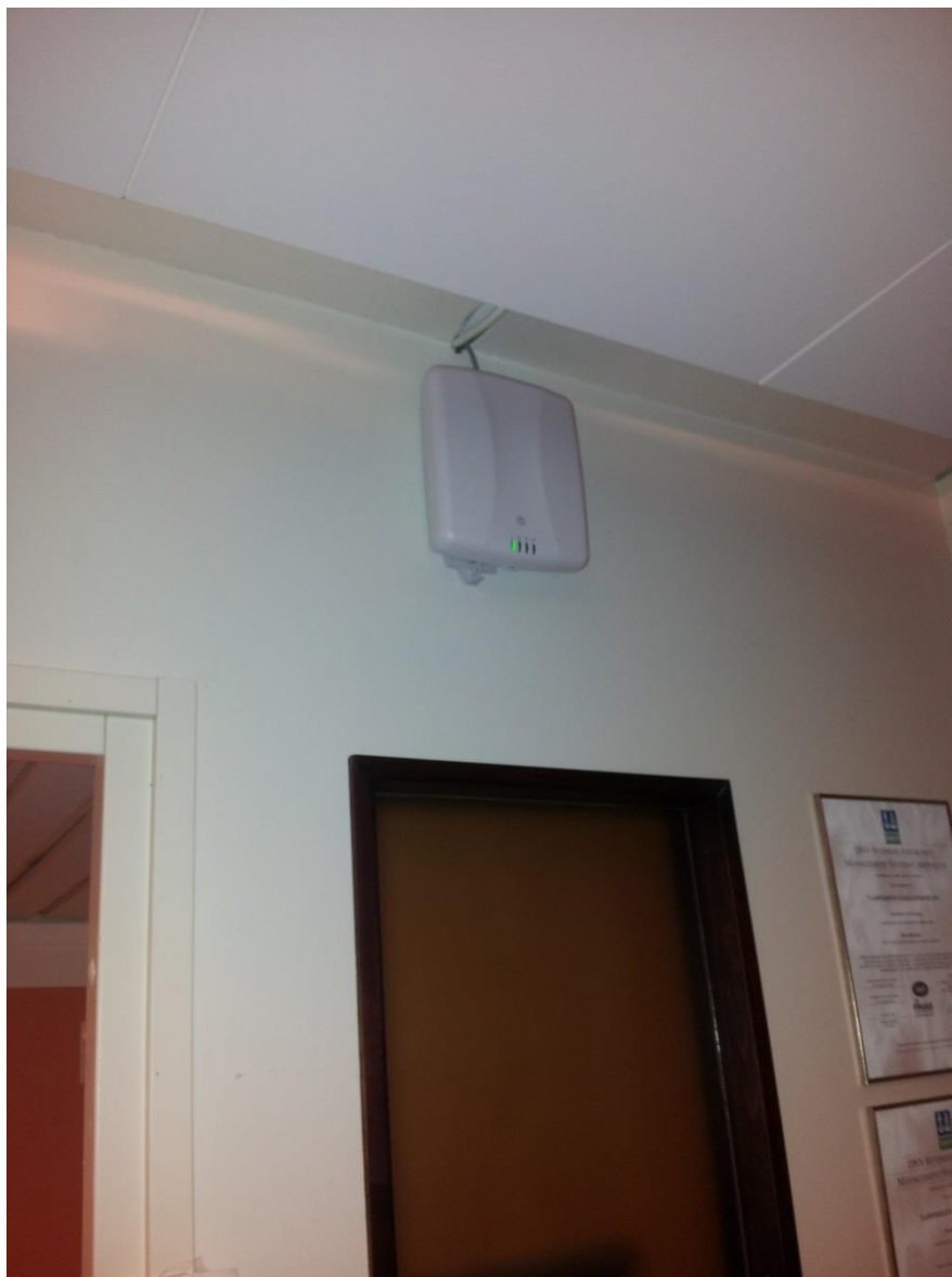
KUVA 14. Tyypillinen tukiaseman asennuspaikka katonrajassa.
