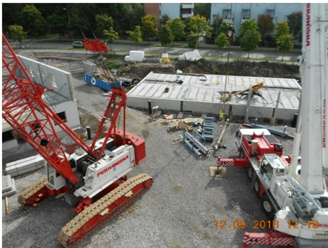
Kuva 1. Elementtiasennus käynnissä kahdella nosturilla ja kahdella elementtiasennusryhmällä NCC:n työmaalla Keravan Ahjossa. Kuva: Miika Piipponen.
