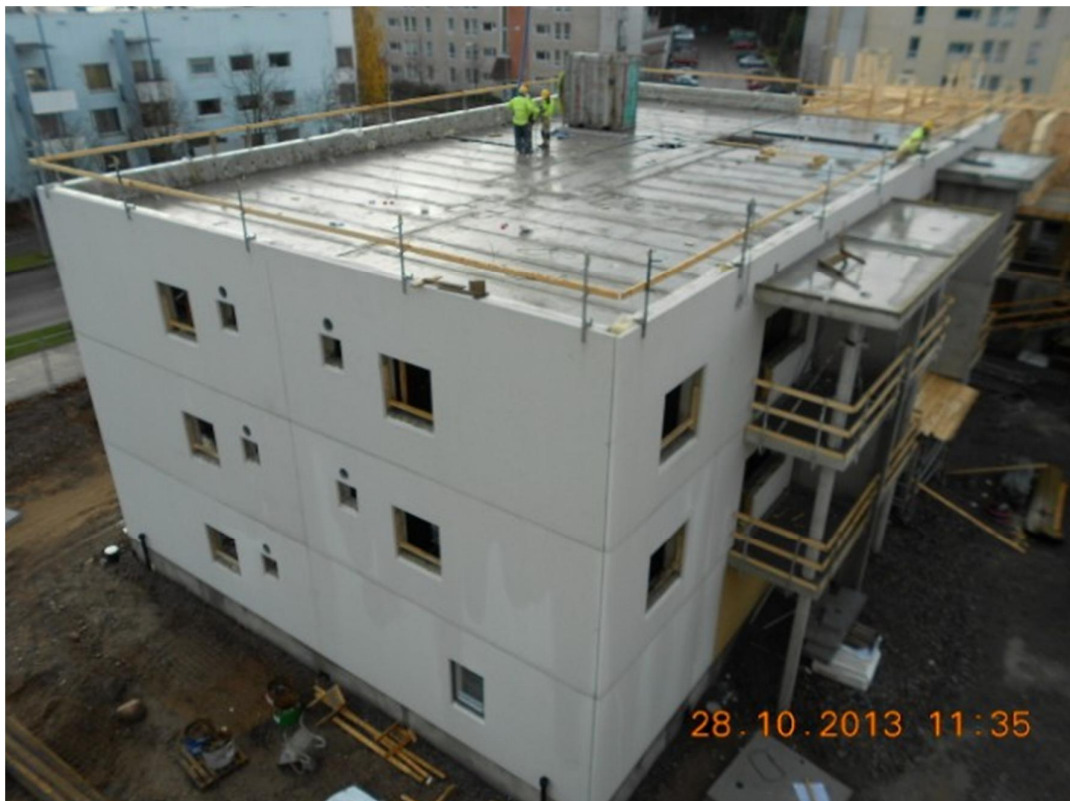
Kuva 3. Viimeisen talon runko pystyssä 4 viikkoa etujassa alkuperäiseen aikatauluun verrattuna. Kuva: Miika Piipponen
